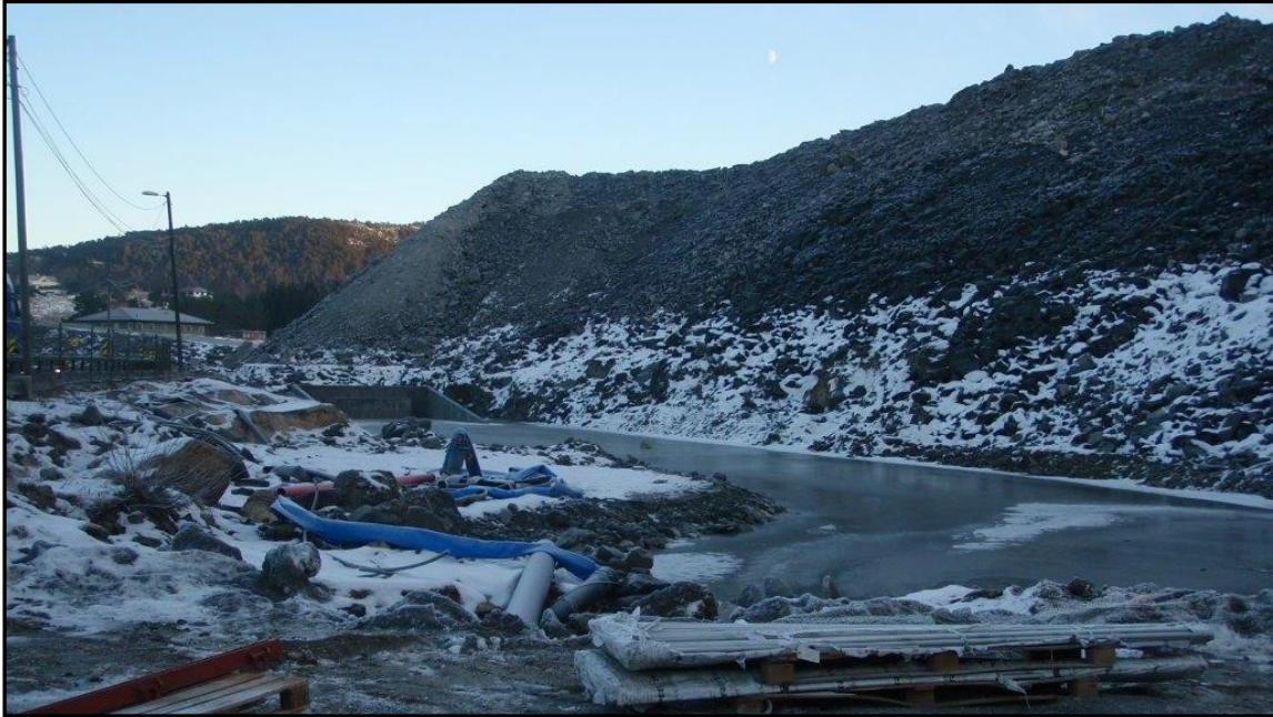
Figur 7.9: Midlertidig lagret sprengstein utenfor østre påhugg av Eikåstunnelen, nord for påbegynt sedimentasjonsbasseng. Foto er tatt mot øst under driveperioden (20. desember 2012), og er gjengitt med tillatelse fra Agnieszka Wyspianska.
