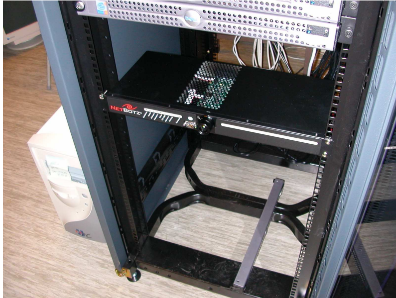
Bilde 6 - NetBotz 320 installert i K19
