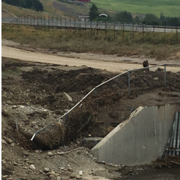
Figur 5-29: Masser avsatt oppstrøms av kulvert under nedbørshendelsen i Juli 2017.
