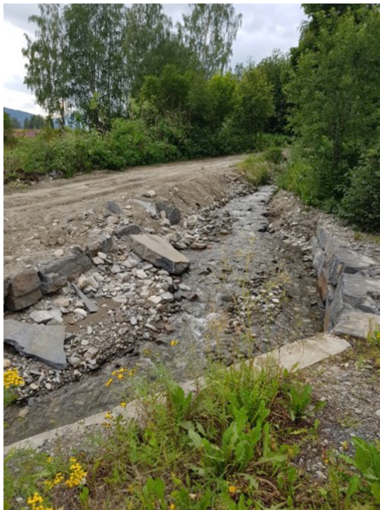
Figur 5-27: Skade oppstrøms av kulvert i Ysterivegen.
