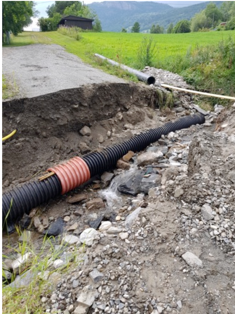
Figur 5-28: Skader på stikkvei fra Ysterivegen.
