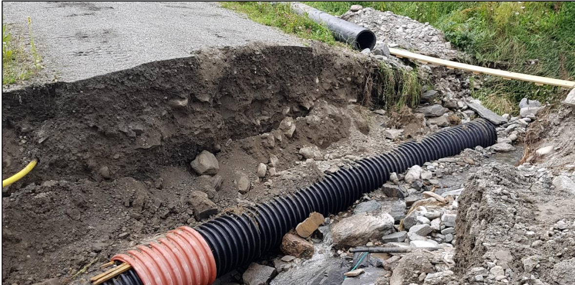
Figur 1-1: Skader på bilvei som følge av at Trilla, sideelv til Brandrudsåa, har gravd seg frem nye veier rundt ei stikkrenne under en styrtflom (Foto: Henning Sigstad, juli 2017)
