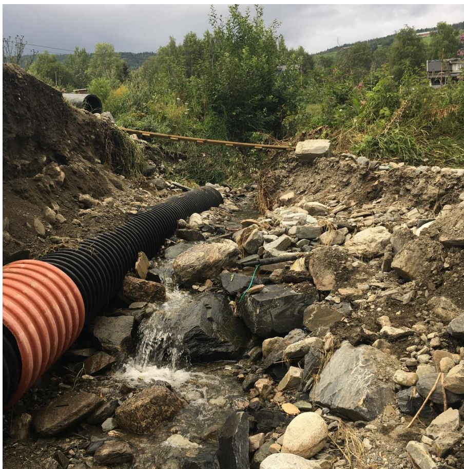
Figur 5-34: Utgravinger gjort av Trilla rundt ei stikkrenne under en styrftom (Foto: Petter Aasen, juli 2017).
