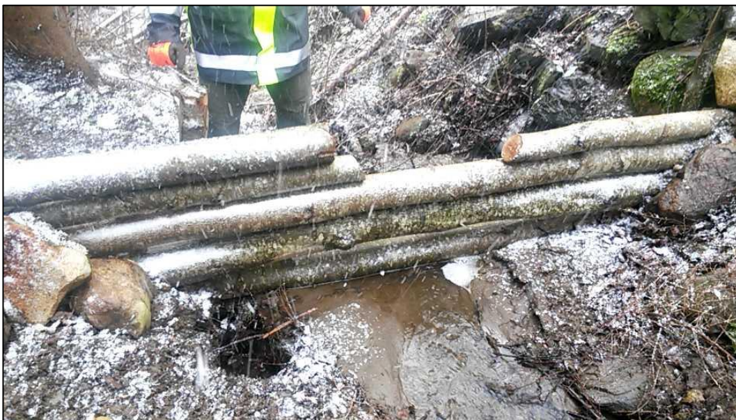
Figur 79: Erosjonshull, stokkdam 1 (høyre side) (Økland, 23.04.2015)
