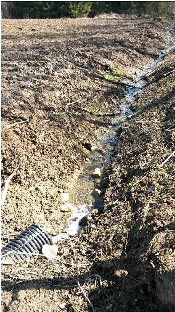
Figur 104: Utløp stikkrenne, og grøfta som går langsmed jordet ovenfor ravinen (Økland, 23.04.2015)
