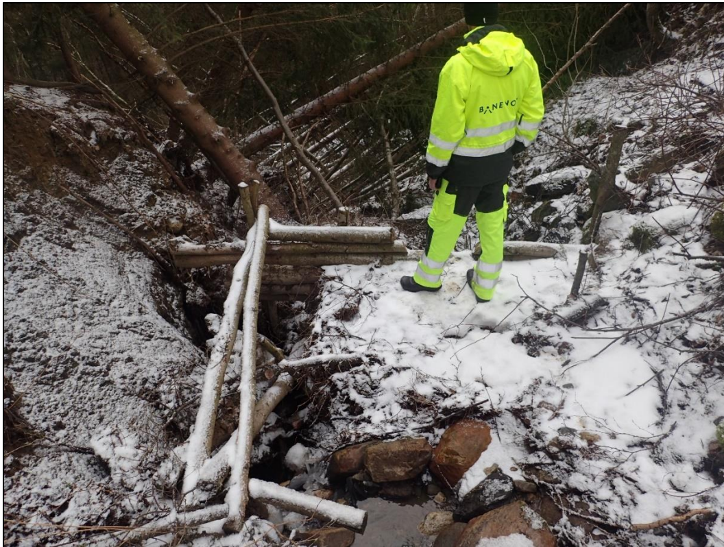
Figur 96: Kraftig erosjon og sedimentasjon, ved stokkdam 1 (Günther, 31.03.2017)
