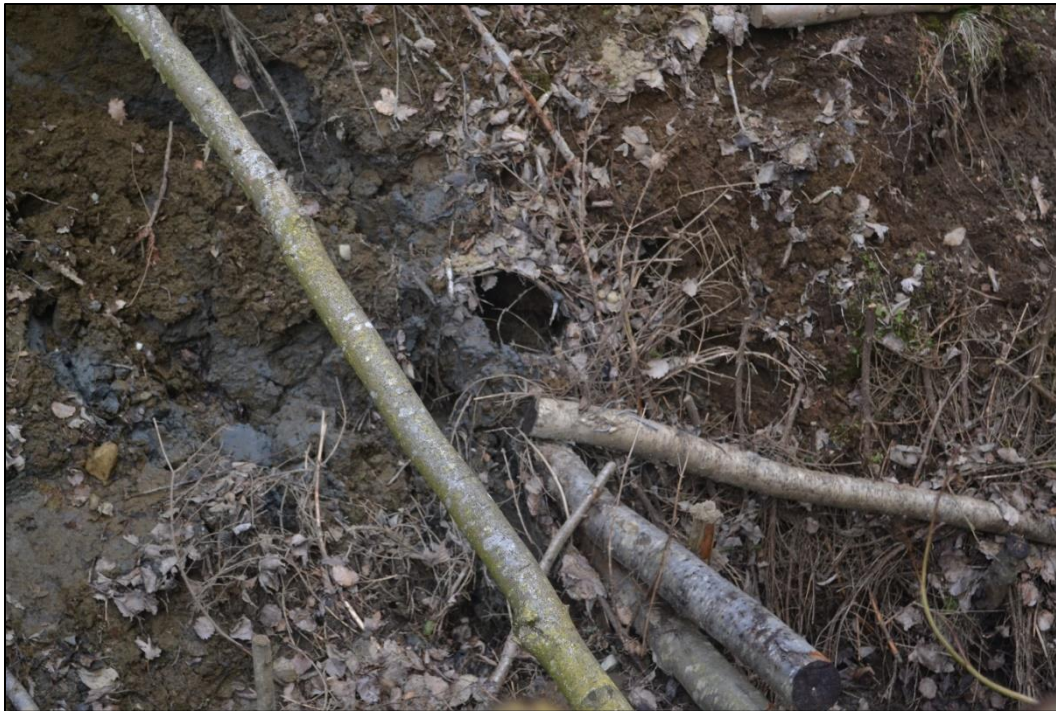
Figur 80: Erosjonshull, stokkdam 2 (høyre side) (Økland, 03.05.2016)
