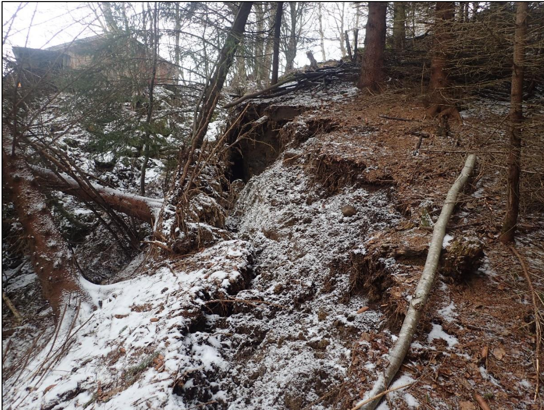
Figur 100: Utglidning, Engan (høyre skråningsside, mellom stokkdam 1 og 2). (Günther, 31.03.2017)
