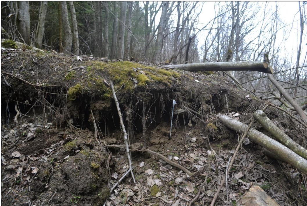
Figur 70: Overheng, høyre skråningsside (Økland, 03.05.2016)
