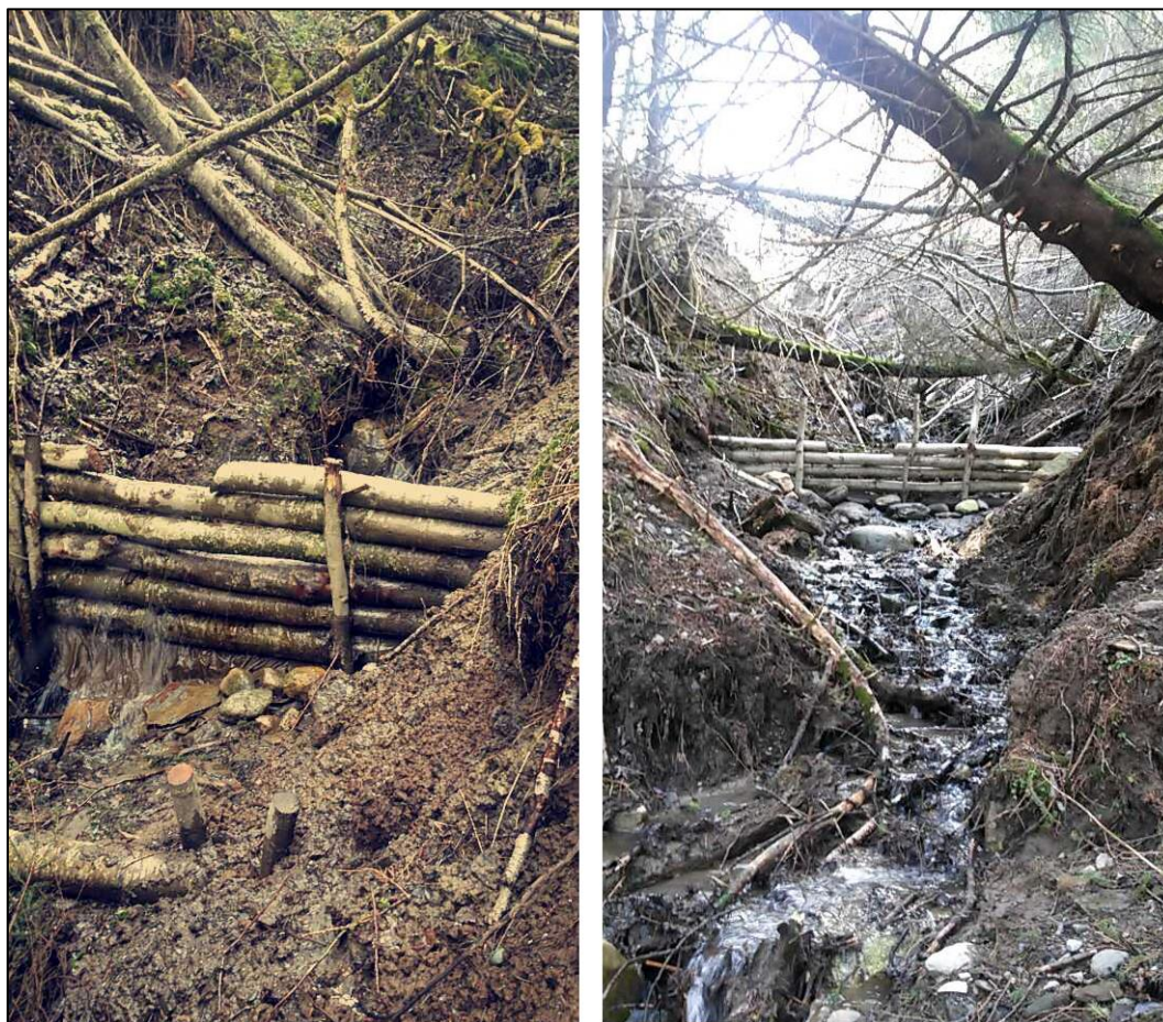
Figur 88: Vannføring ved stokkdam 2 (venstre) og stokkdam 4 (høyre), våren 2015 (Økland, 23.04.2015)
