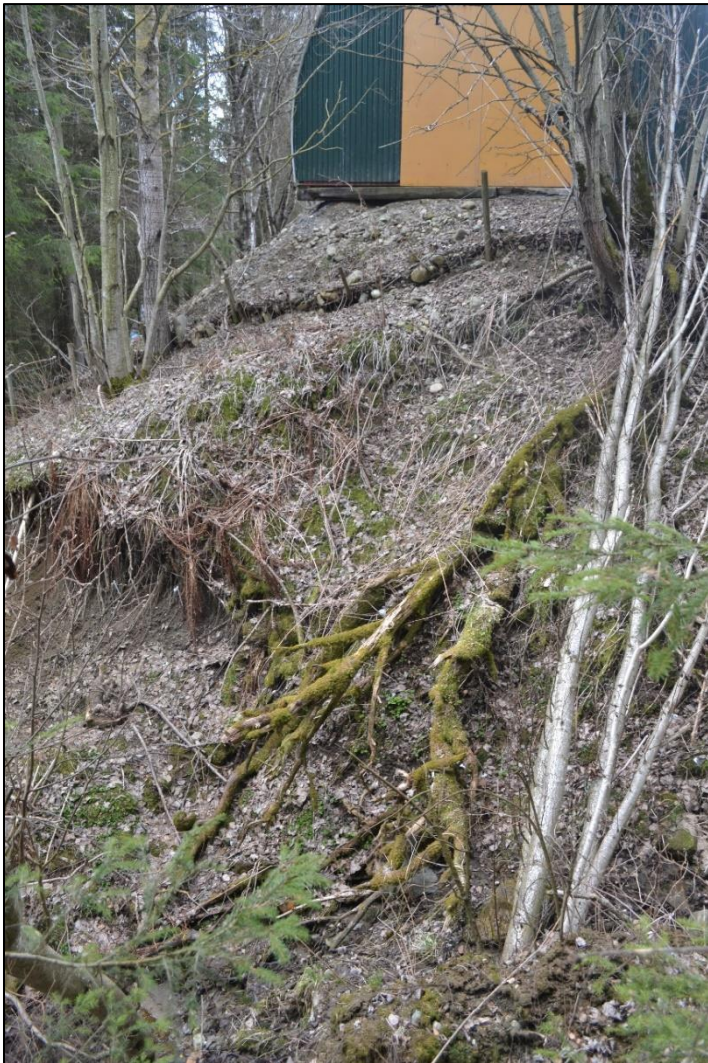
Figur 105: Tegn på massetap ved/under bygning på oversiden av skråningen, venstre side (Økland, 03.05.2016)
