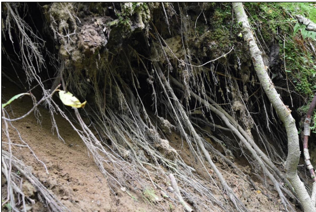
Figur 69: Blottlagte røtter, høyre skråningsside (Økland, 29.08.2016)
