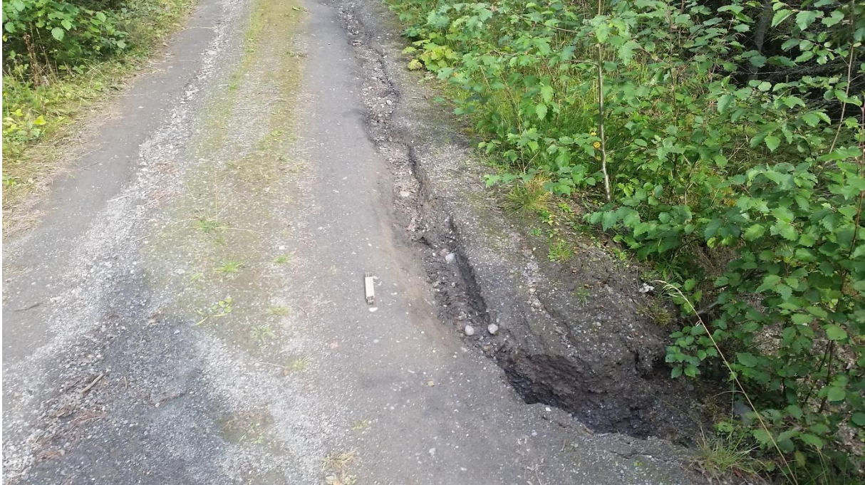
Figur 53: Erosjon langs skogsbilveg i nordre delar av feltområdet (nord aust for 046). Erosjonsspora kan følgjast opp til GPS punkt 047, og ser ut til å halde seg i hjulspora før dei endar i denne gropa som går ned på eit naturleg bekkefar. Massane verkar stabile, men mindre sprekkar kan observerast langs kantane, noko som kan føre til at gropa seinare utvida seg. Foto er tatt mot NØ (Dato: 14.09.2017).
