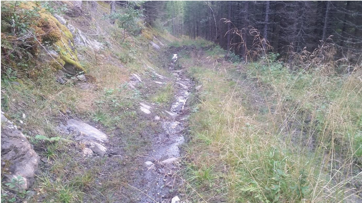
Figur 55: Drenering av vatn langs driftsveg frå Figur 51 . Vatnet konsentrera seg langs eine vegsporet, og fører til fordjuping av sporet via erosjon. Vatnet fortsette vidare fram til grøfta nedst i bildet, der det meste tek av mot høgre og ut i skogen. Grøfta verka nokså fersk, og kan derfor ha blitt greve som eit dreneringstiltak for å hindre større vassføring. Fotoet er tatt ved punkt 039, i reiming NØ (Dato:14.09.2017).
