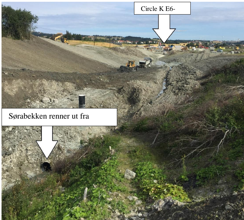
Figur 4.8 Oversiktsbilde oppstrøms SOR-2. Pilen øverst i bildet viser skadestedet, og pilen nederst i bildet viser hvor Sørabekken renner ut av kulvert. SOR-2 er plassert ca. 50 m nedstrøms kulvertens utløp. Området mellom bensinstasjonen og SOR-2 er sterkt preget av pågående anleggsvirksomhet.
