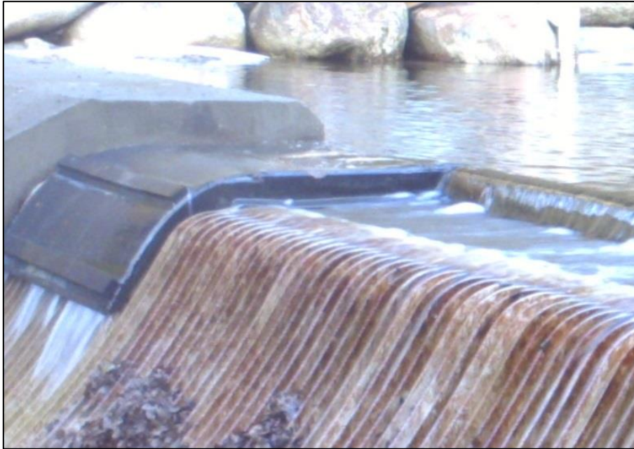
Figur 3 Snorkelen i drift sett fra lukehuset
