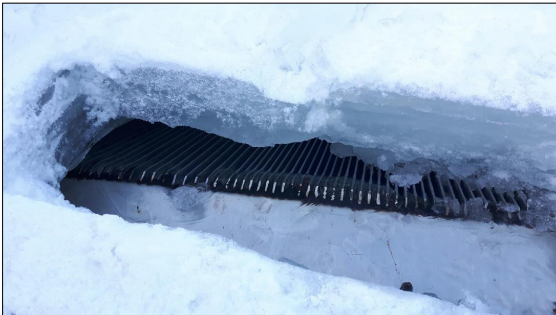
Figur 33 Ny rist ved Tverråni
