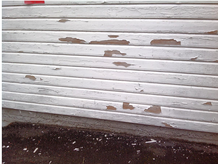
Figur 61: Husvegg som bærer preg av dårlig vedlikehold og dermed kan fungere som aktiv kilde til miljøgifter (Foto: Bjørn Eidem)
