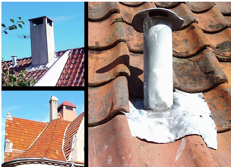
Figur 6: Blybeslag på hustak i Gamle Stavanger (Foto: Bjørn Eidem)
