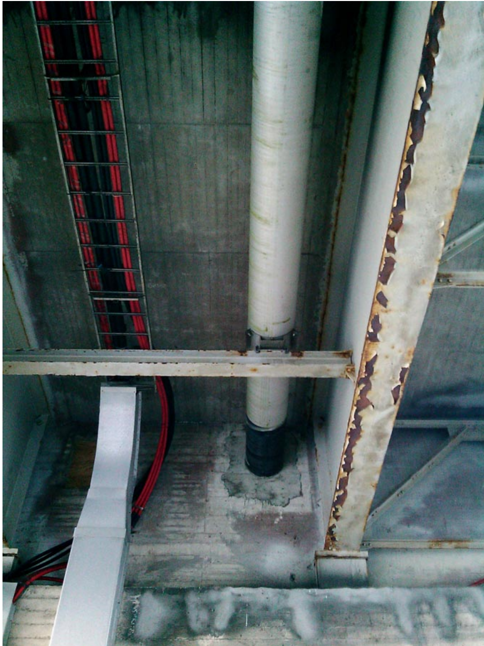
Figur 57: Avflassing av maling på undersiden av Strømsbroen (Foto: Bjørn Eidem)
