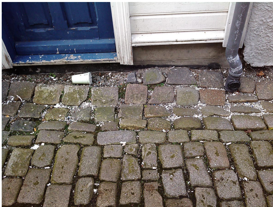
Figur 2: Tydelige malingsrester rundt et nylig oppusset hus (Foto: Bjørn Eidem)
