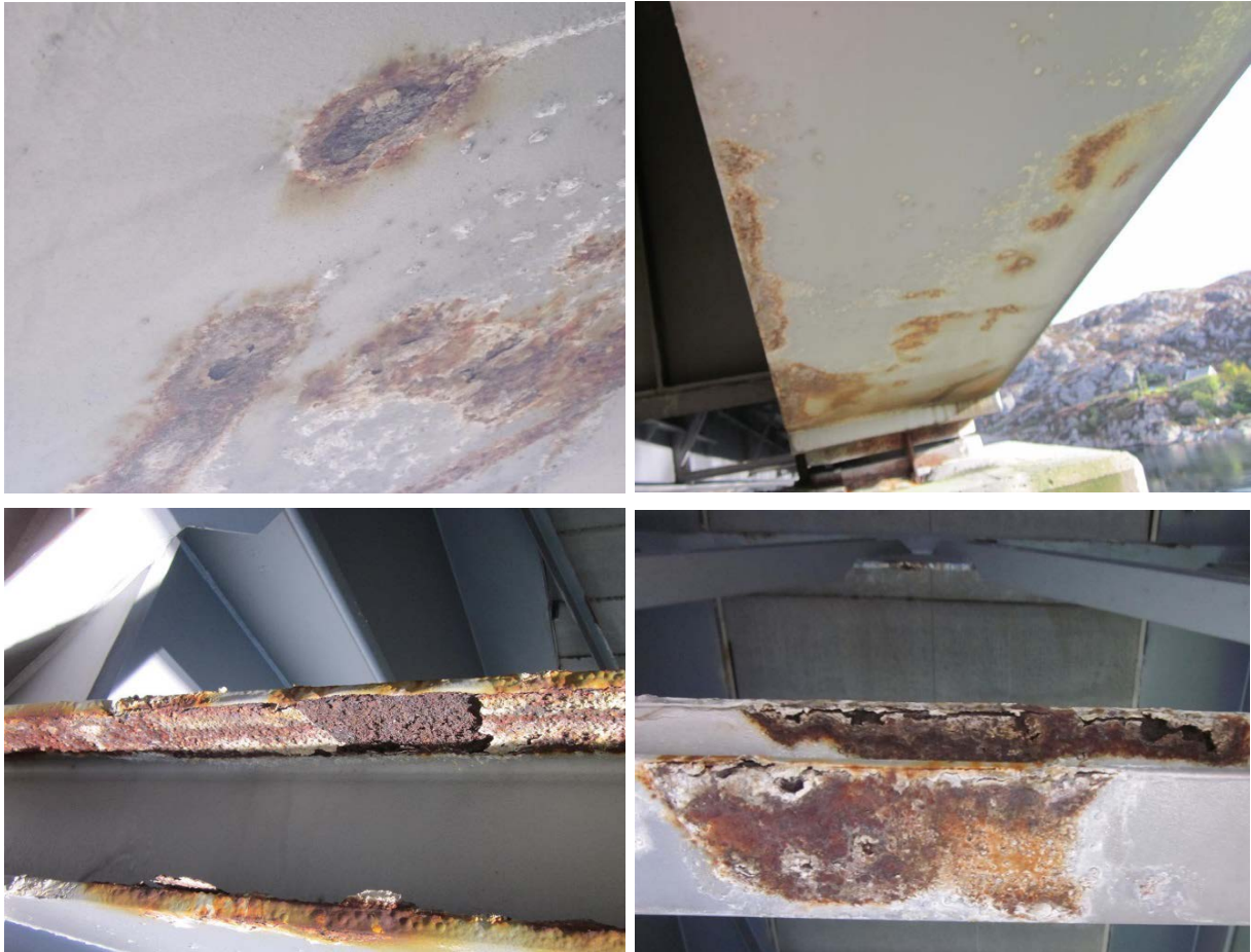
Figur 28: Djupasund, nedbrytning av belegg, mai 2017 (Foto: SVV)
