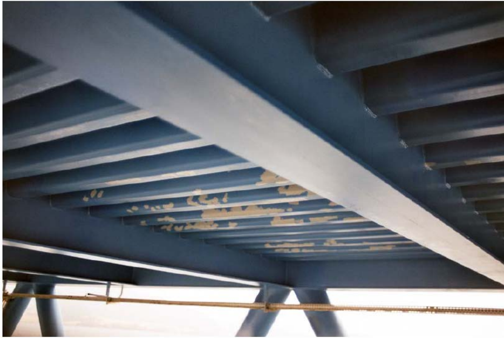
Figur 21: Bergsøysundbrua, flekkvedlikeholdt med epoksymastik i 2002. (Foto: Jan Scheie)
