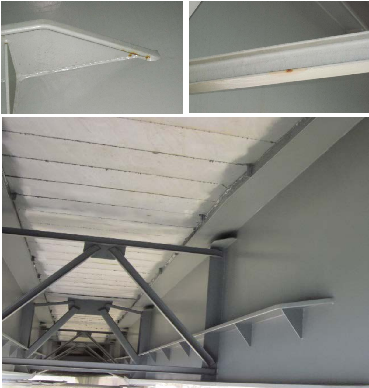
Figur 29: Klubbasund, tilstand på overflatebehandling, mai 2017 (Foto: SVV)
