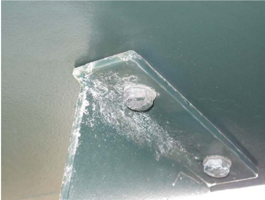
Figur 34: Osterøybrua, hvitrust på innfesting av ledeskovler (Foto: SVV)
