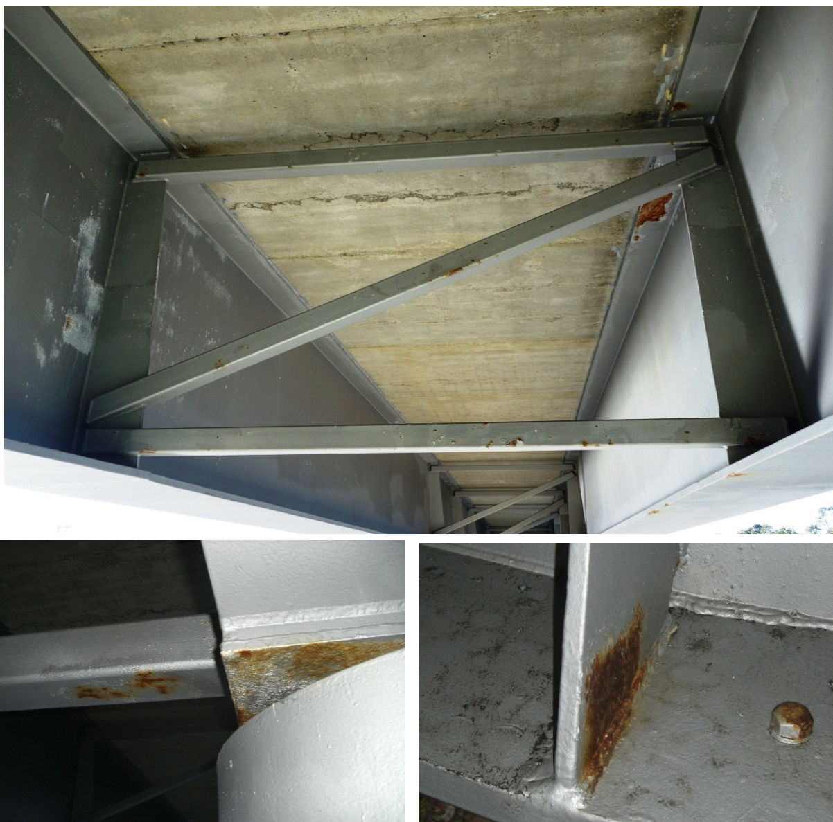
Figur 31: Bukkholmstraumen, tilstand før vedlikehold 2013 (Foto: SVV)
