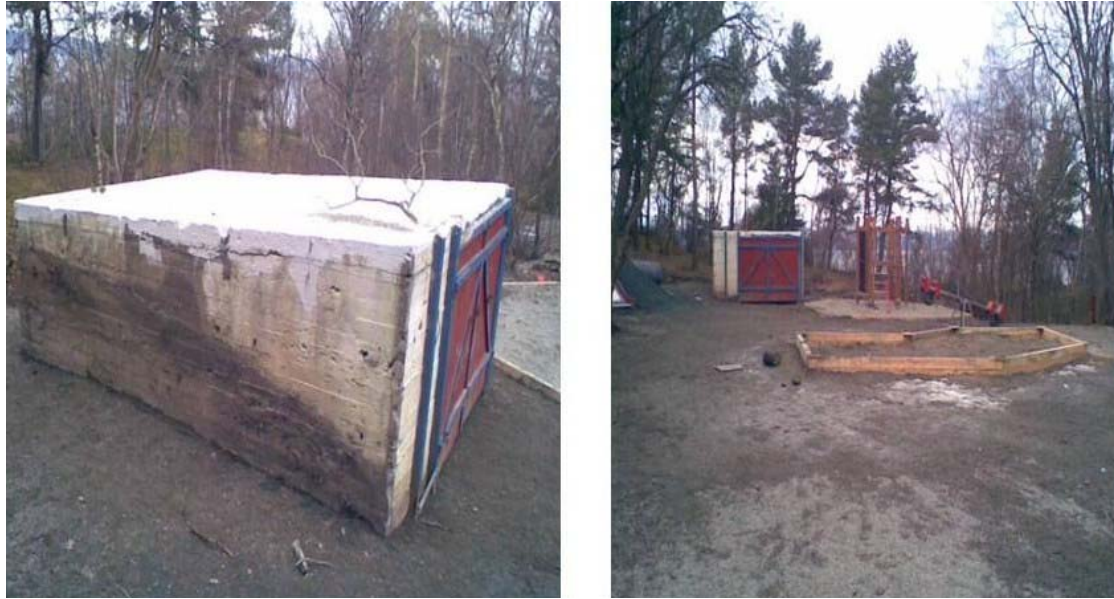
Figur 64. Etter tiltak i Spannet barnehage. Taket med tjæremaling og 30 cm av det øverste jordlaget er fjernet.
