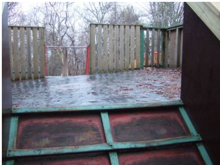
Figur 60. Tjærebelagt tak på bunker som kilde til de forhøyede verdiene av PAH i Spannet barnehage.
