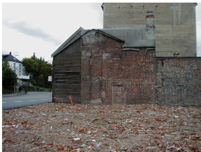
Figur 20: Både riving og rehabilitering av bygg fører til at det genereres avfall som kan inneholde miljøgifter (Ottesen 2009).
