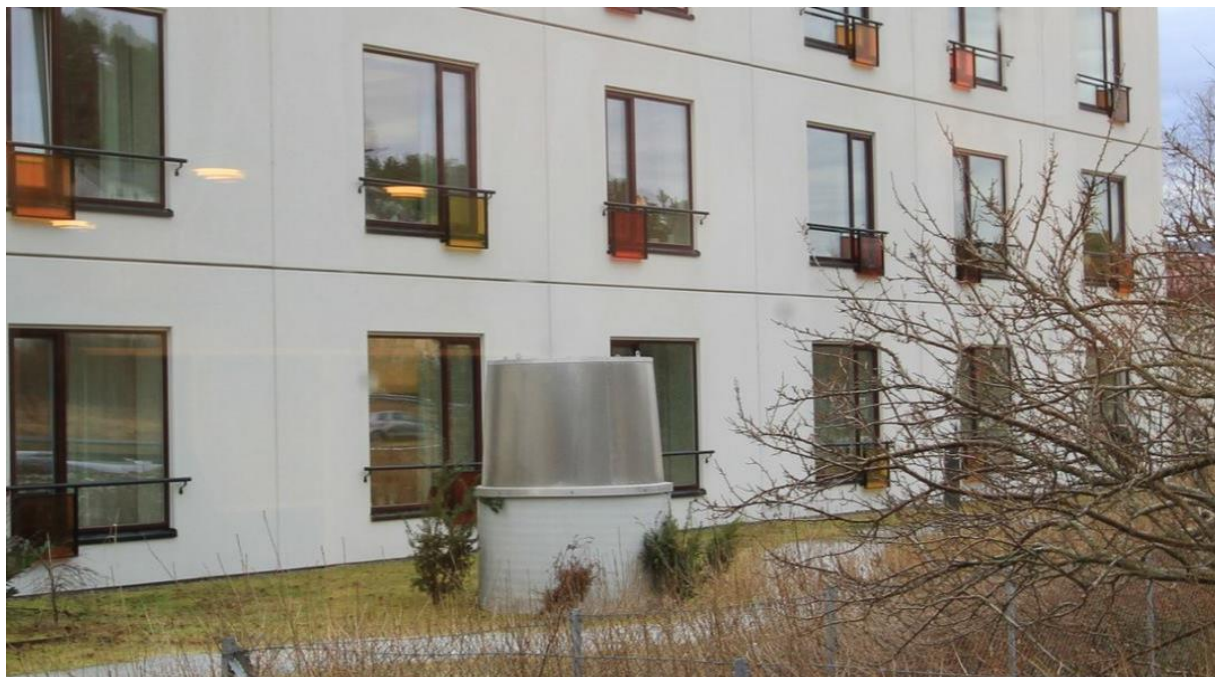
Bilde 4- Luftinntak Hatlane omsorgssenter
