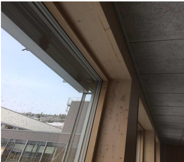
Bilde 13- Utvendig solavskjerming Romsdal vgs.
