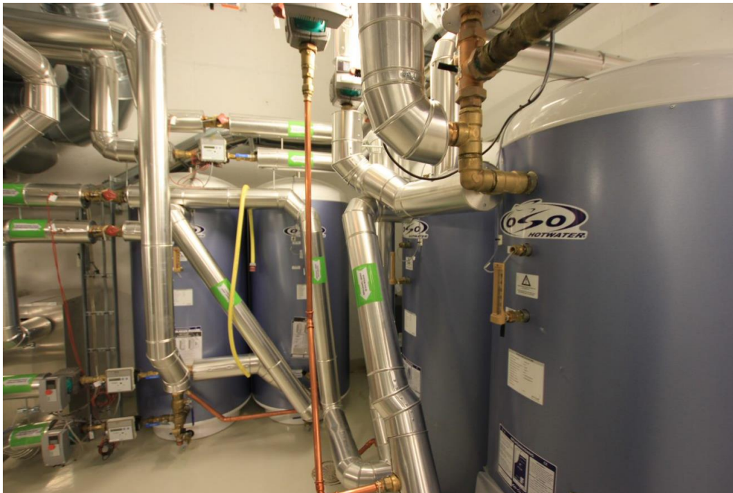
Bilde 3- Varmtvannsberedere Hatlane omsorgssenter
