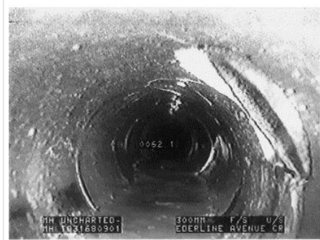
Figur 4-27: Dårlig utførelse av stikkledning (Davies et al., 2001)
