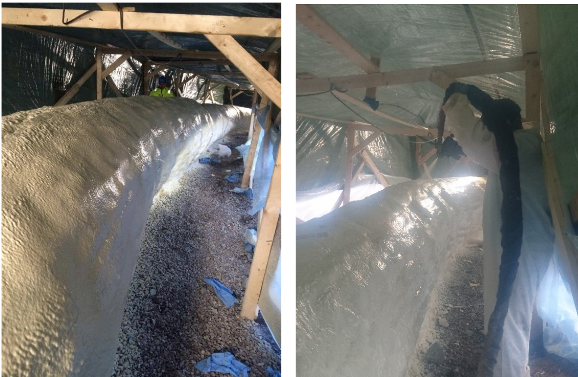
Figur 25 Telt for oppvarming av røroverflaten
