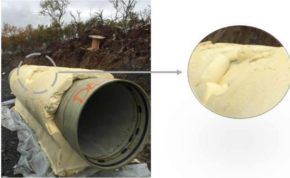
Figur 27 Hulrom i PU-skummet rundt rørperiferien
