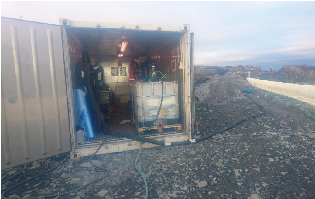
Figur 52: Konteiner med pumpeutstyr og beholdere med polyol og isocyanate
