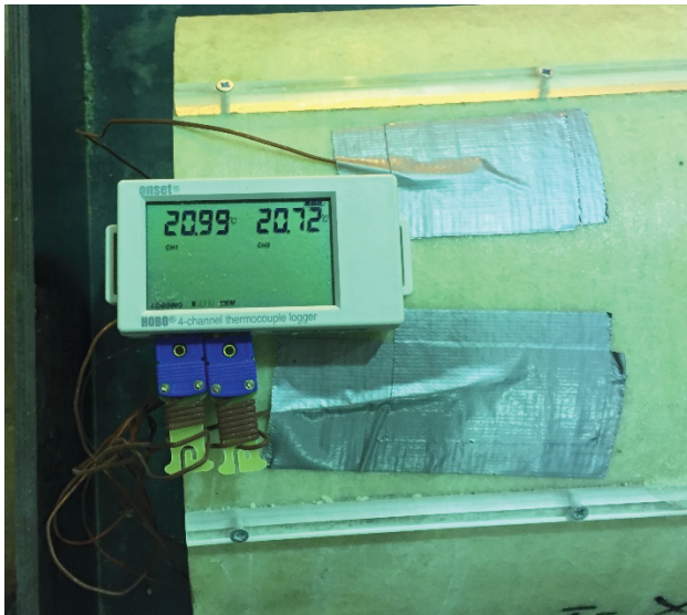
Figur 33: Temperaturmåler Hobo UX120-014M. Målepunktene er under ductapen.
