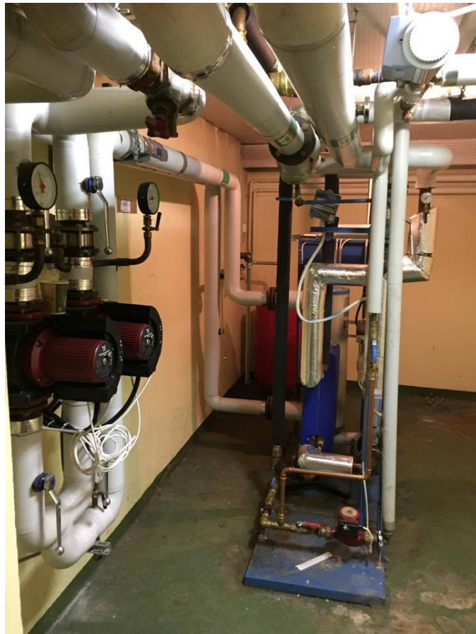
Figur 4.1: Undersentral, Haugerud Borettslag
