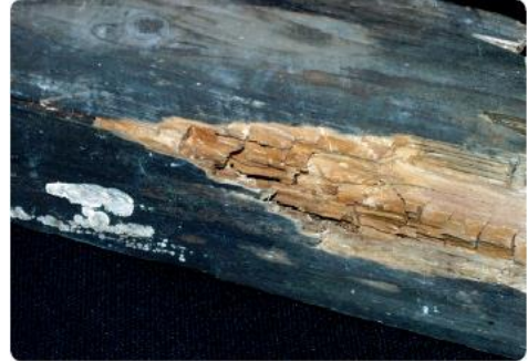
Figur 17: Omfattende, innvendig brunråteskade i en bjelke(SINTEF Byggforsk, 2007).
