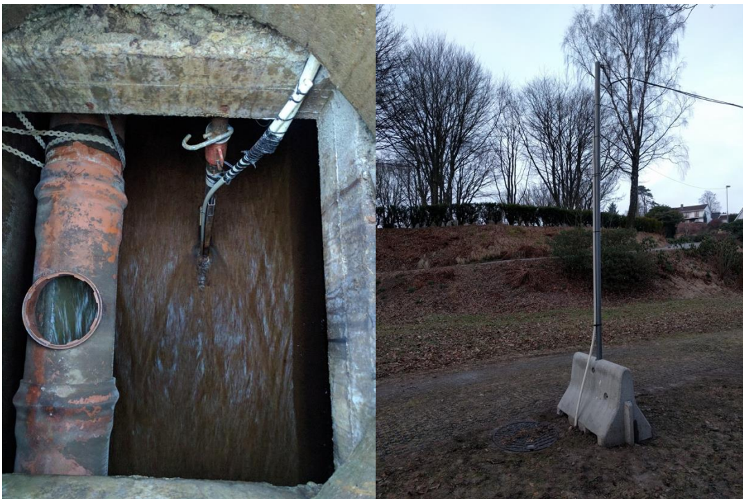
Figur 41: Venstre: innsiden av kulvert. Høyre: dataoverføring (Foto: Sigmund Wiig Petersen).
