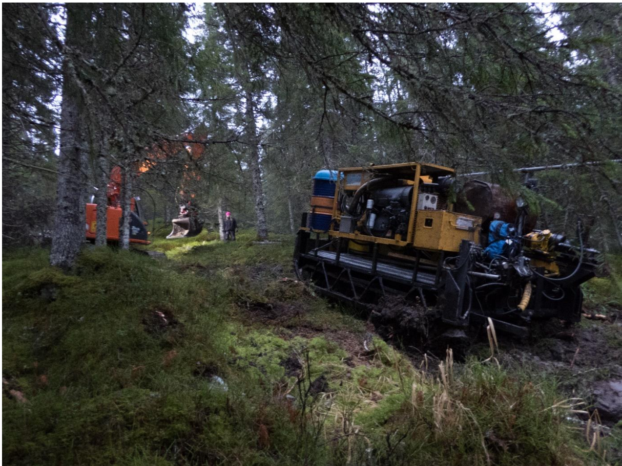
Figur 8: Bilde fra feltarbeidet. Boreriggen manøvrerer seg gjennom terrenget ved hjelp av en gravemaskin.
