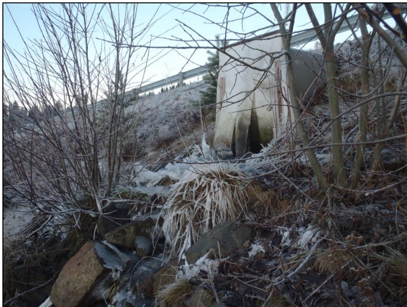
Figur 27. Utløp Ø1. Fortsatt fiberduk i 2015, som ble satt opp i 2013.
