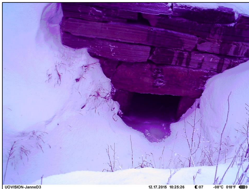
Figur 83. Snø har vært en viktig del av isoppbyggingen i stikkrenne D3. Her begynner vann å smelte noe av snøen mens det renner ut, og bidrar til isoppbyggingen, 17.12.16.
