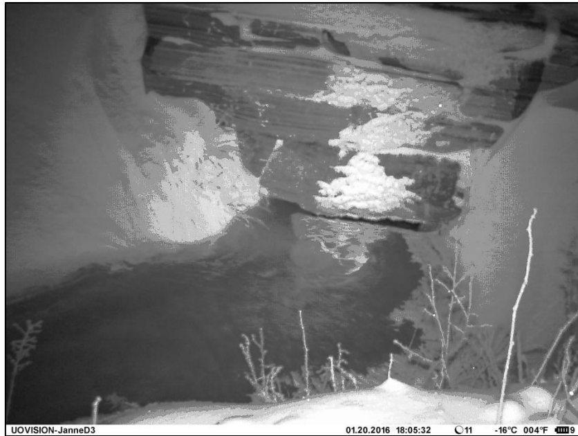
Figur 84. Isen har fylt store deler av bekkeløpet, og innløpet på stikkrennen er nesten tett 20.01.16.
