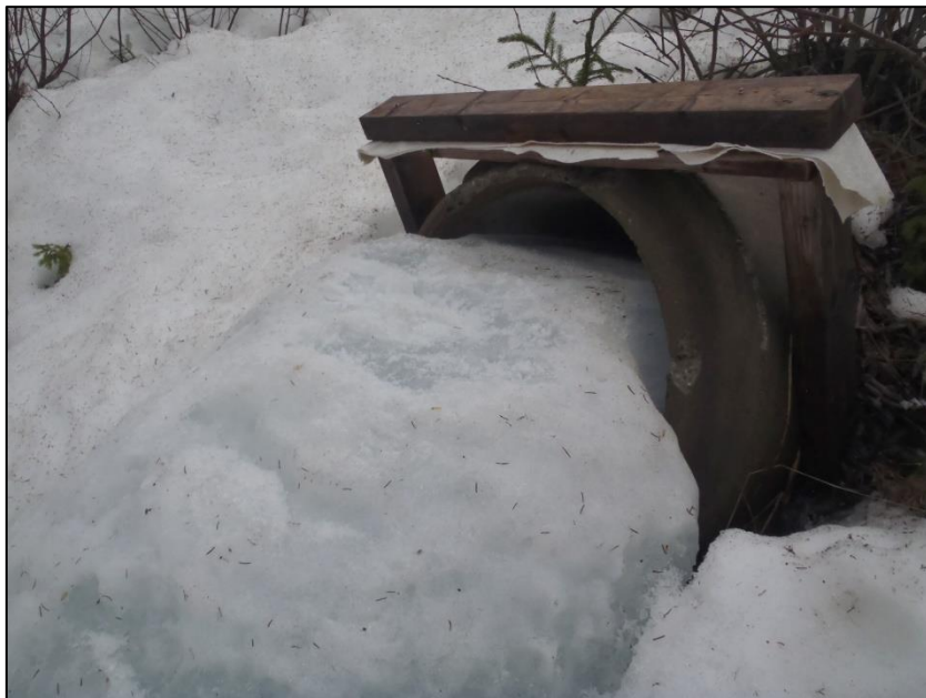
Figur 88. Observert svellis i utløp på stikkrenne Ø2.
