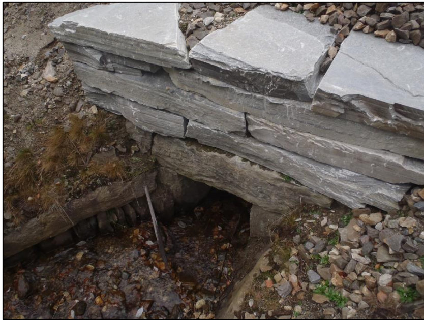
Figur 36. Km 318,780. Innløp stikkrenne D3, hvor det vanligvis kjøver ved innløp.
