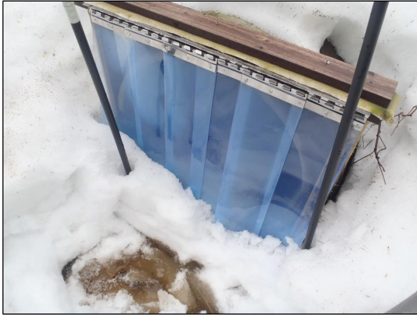
Figur 89. Ingen særlig isdannelse observert ved utløp på stikkrenne Ø3.
