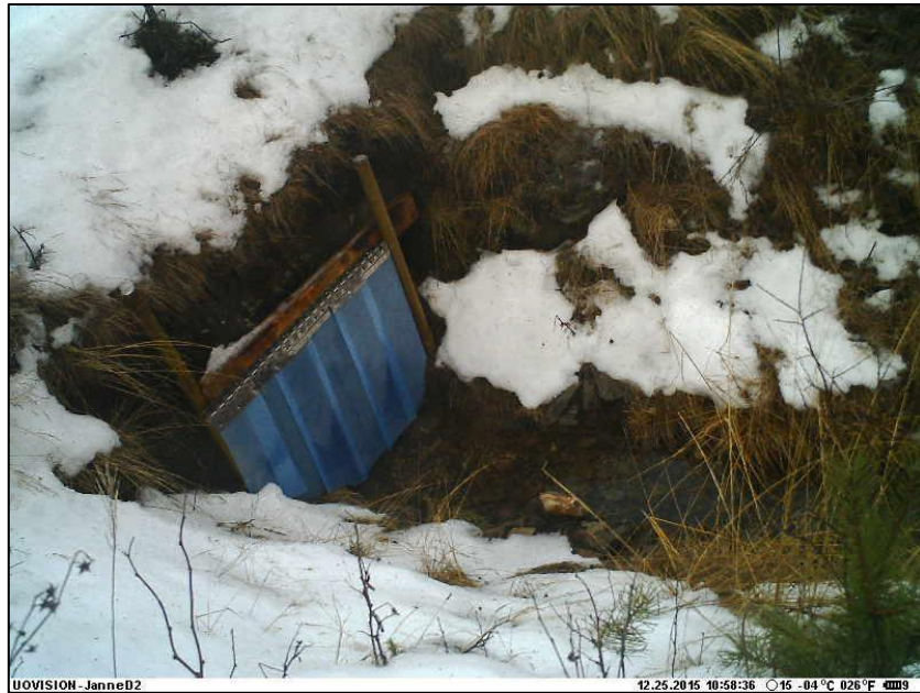
Figur 77. Dugg på innsiden av plaststrimlene 25.12.15, ved stikkrenne D2 i Dovre.
