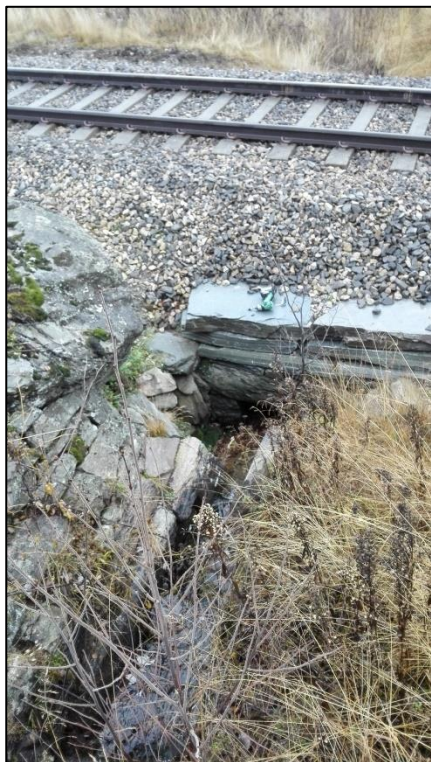
Figur 40. Tilløp og innløp på D2, sett fra området hvor temperaturmåler i luft er festet. En smal murt renne leder ned mot innløpet av rennen.
