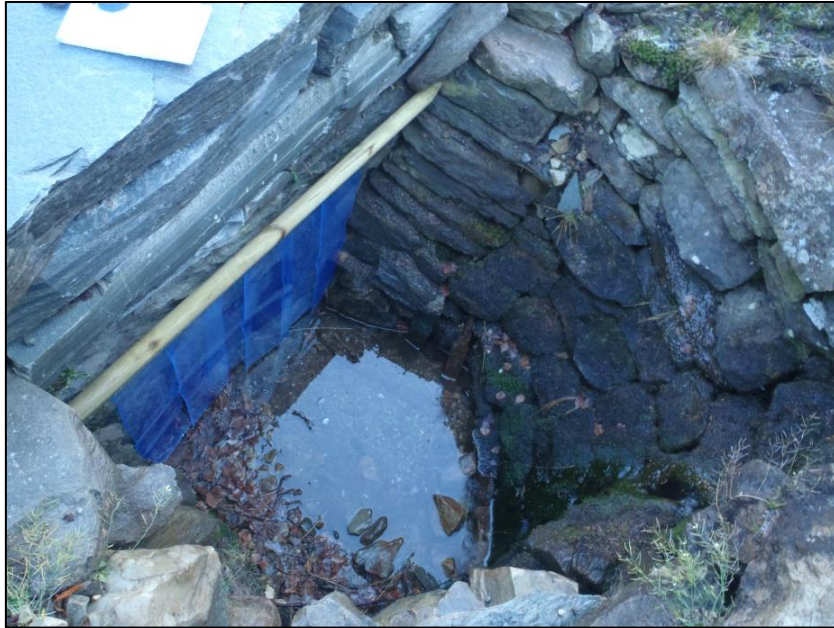
Figur 15. Innløp på stikkrenne D2 i Dovre.
