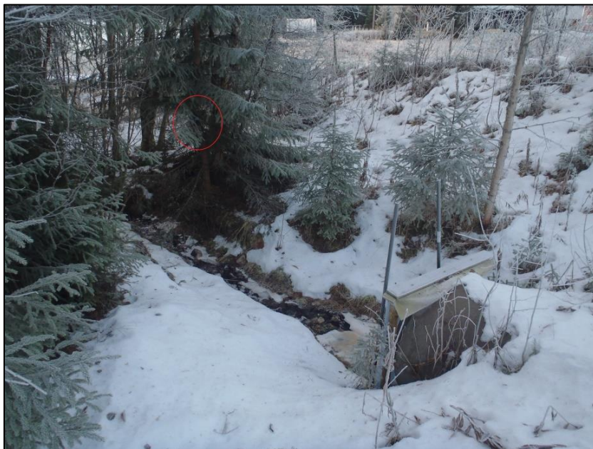
Figur 21. Utløp stikkrenner Ø3 sett fra vegen. Viltkamera markert med rød sirkel, nokså godt skjult.
