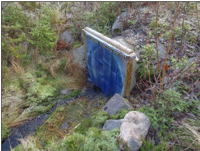
Figur 16. Kuldeskjørt av plaststrimler foran innløp på stikkrenne Ø3 i Trysil.
