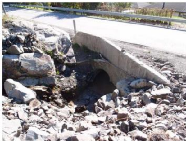
Figur 5.3: Blokkert kulvert ved Askjellerudebekken, Åretta nedbørfelt, som vil kunne endre dreneringen (Lillehammer kommune 2014).
