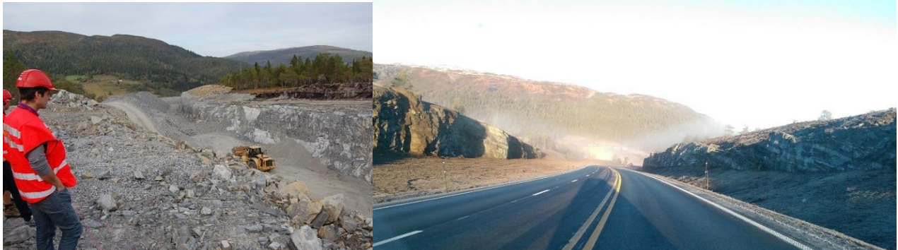
Figur 71: E39 Halsteinbrua - Høgkjølen. Bildet til venstre viser inngrepet i anleggsfasen. Bildet til høyre viser ferdig anlegg.
