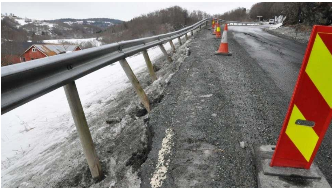
Figur 68: Viser ødelagt rekkverk på fv. 802 i Skaun kommune. En kan også se at det mangler rekkverk mot stigende terreng på høyre side av vegen (Kilde: Avisen Sør-Trøndelag)
