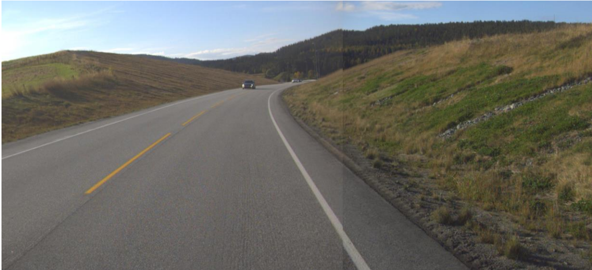
Figur 74: Viser E6 nord for Nes-brua i Grong kommune (Harran). Dette vegprosjektet ble ferdigstilt i 2003/2003. Nord for Nesbrua er det store løsmasse-skjæringene. Disse skjæringene er gitt en slakere helning enn 1:2 og gjør inngrepet mindre brutalt (Kilde: NVDB).
