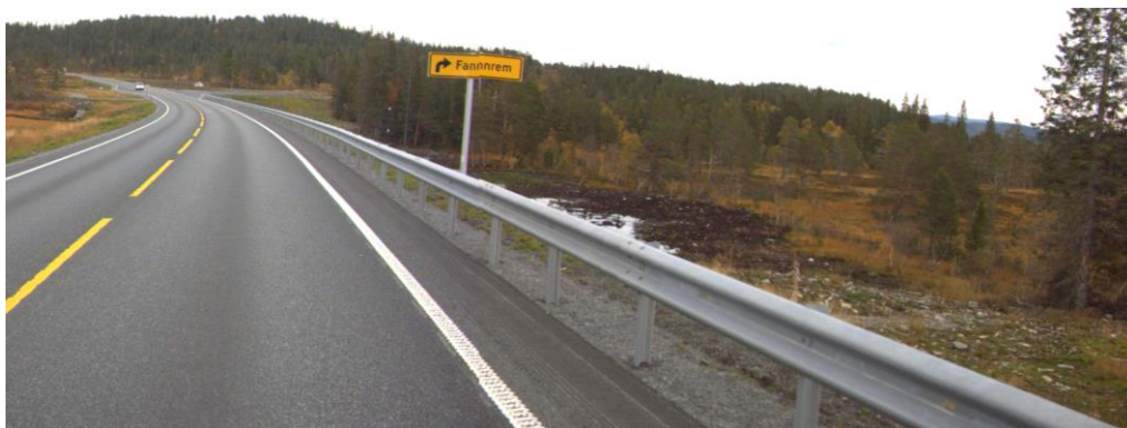
Figur 43: E39 sett fra ca. profil 15400 til 15200 i retning Harangen. I dette området kunne det ha vært vurdert alternativer til rekkverk (Kilde: NVDB).
