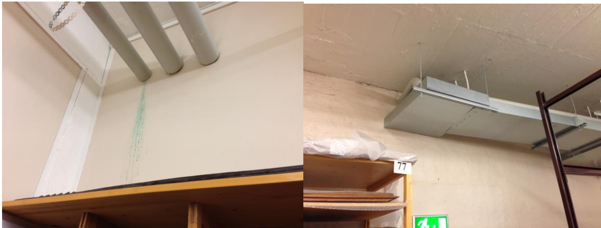
Figur 7: Risikobelagte rørføringer i arkeologisk våtmagasin, med forsøk på sikring av disse innen eksisterende arealer. Foto: Torkel Johansen.
