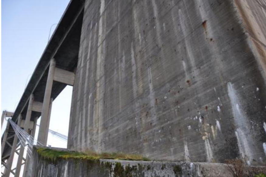
Figur 12.5 Utfelling av alkaligel i riss på nordsiden av forankringspilaren.
