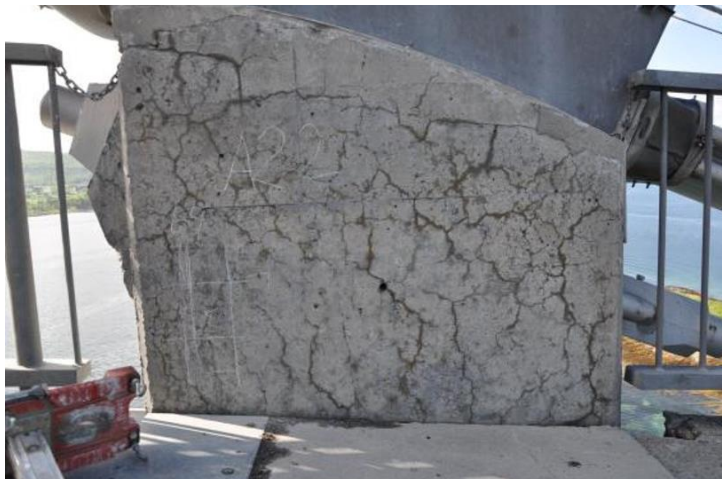
Figur 12.6 Krakeleringsriss på kabelsadel i akse 22.
