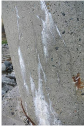
Figur 12.8 Utfelling av alkaligel ved fundament i søyle.
