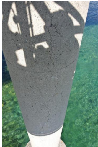
Figur 12.7 Riss i søndre pilar i akse 4.
