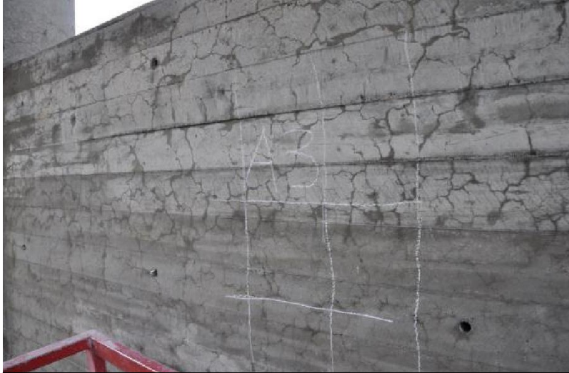
Figur 12.9 Krakelingsriss i rigelen mellom søylene i akse 3.
