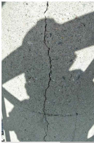
Figur 12.8 Vertikalt riss i søndre søyle i akse 3.
