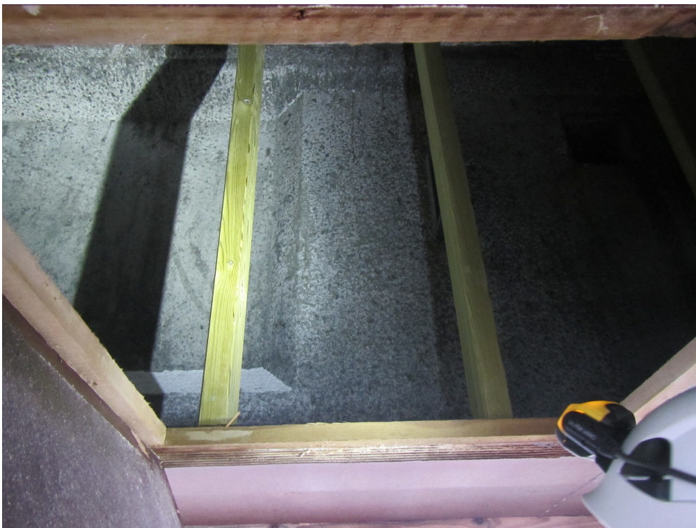
Figur 4.22: Kalkutslag på NIB-bjelke. Bilde er tatt skrått opp fra inspeksjonsluke
