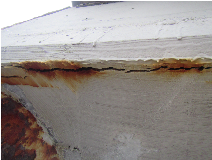
Figur 4.18: Horisontale riss på unersiden ved søylen
