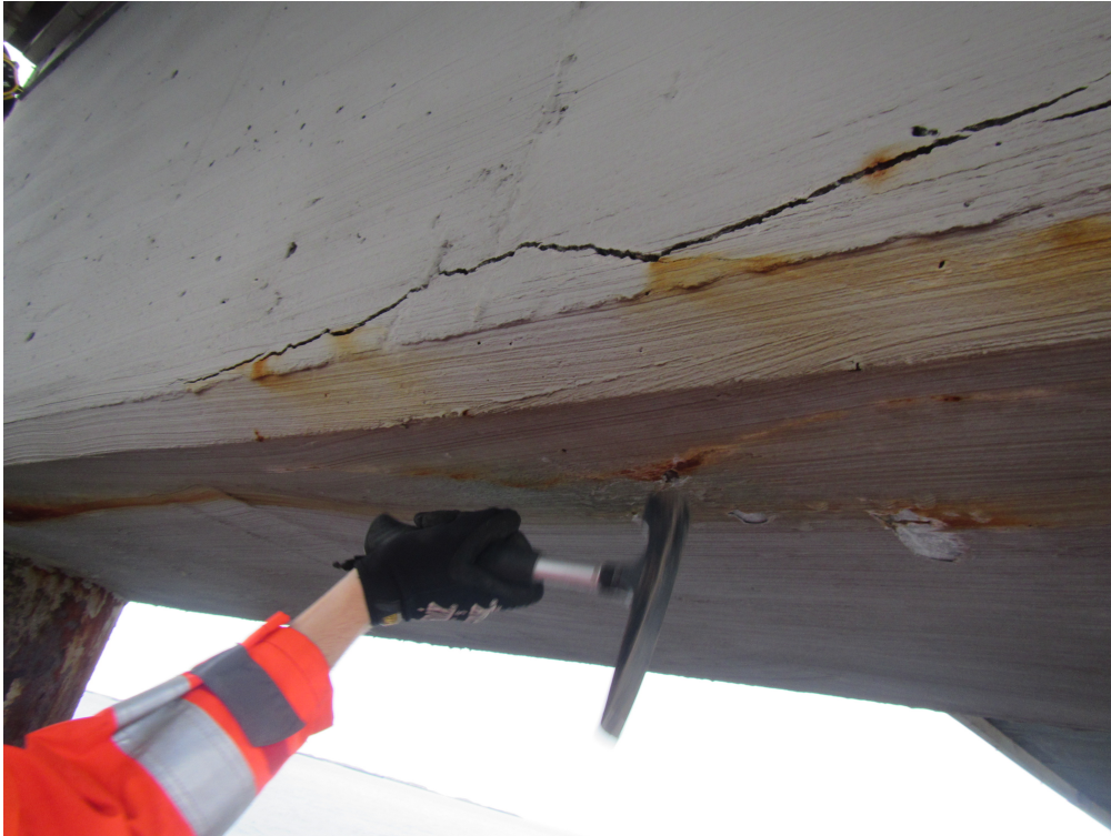
Figur 4.15: Bom på underside
