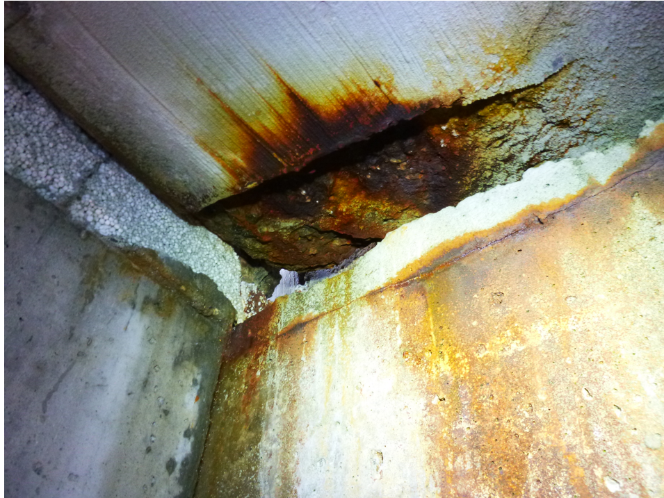
Figur 4.9: Utvasking mellom landkar og bruplate. Man ser den ene NIB-bejlen til venstre i bildet med landkar til høyre og bruplate øverst.
