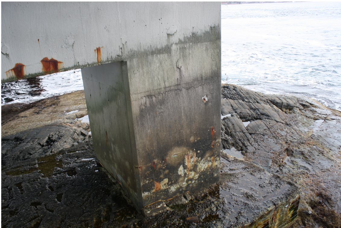
Figur 4.5: Synlig armering på fundament, og synlig korrosjon på søyle og tverrbærer
