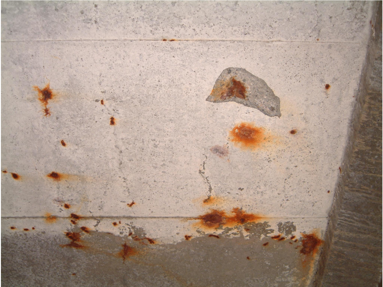
Figur 4.24: Bom og utfelling av rust. Bilde er tatt av de samme skadene som bilde over
