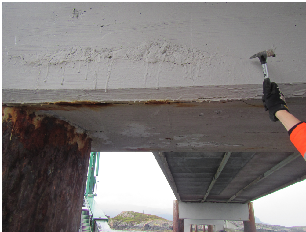
Figur 4.20: Riss og bom ved søylen
