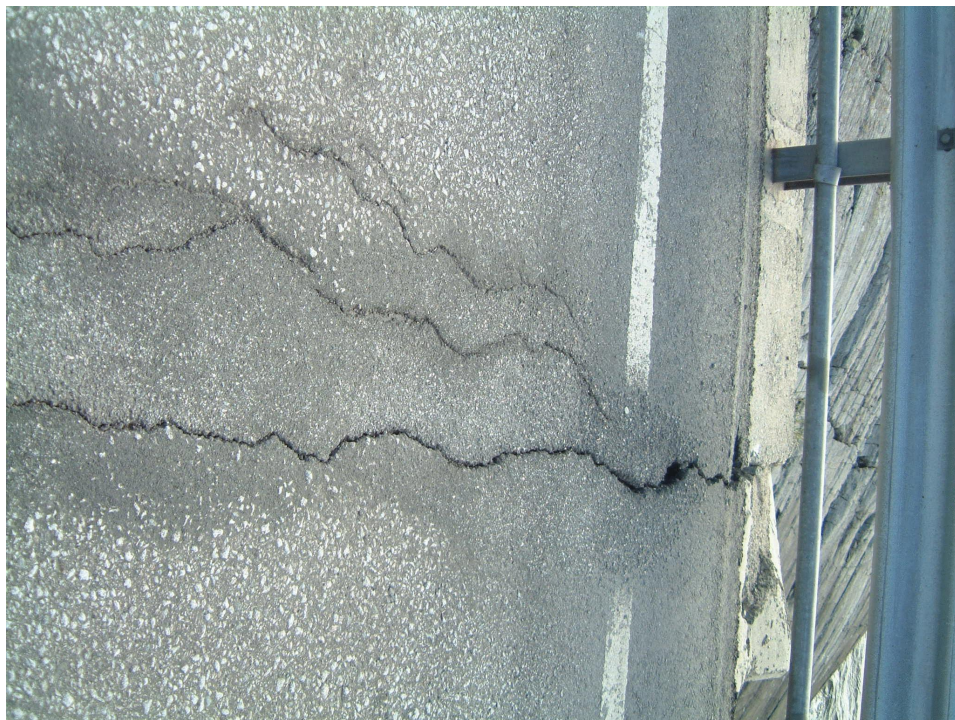
Figur 4.10: Sprekker i asfalt
