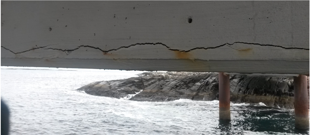
Figur 4.13: Tykke horisontale riss. Bilde er tatt i retning mot Storseisundet bru
