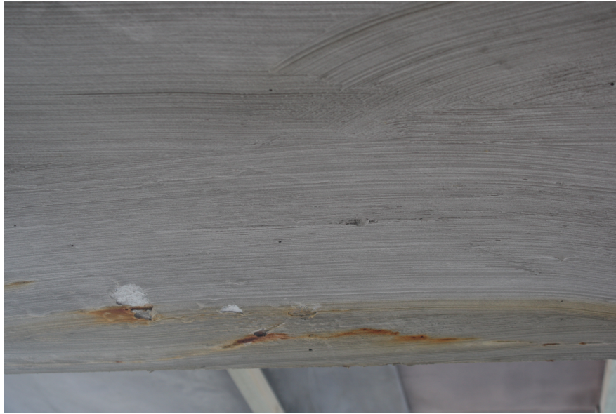
Figur 4.17: Bom på undersiden av tverrbæreren
