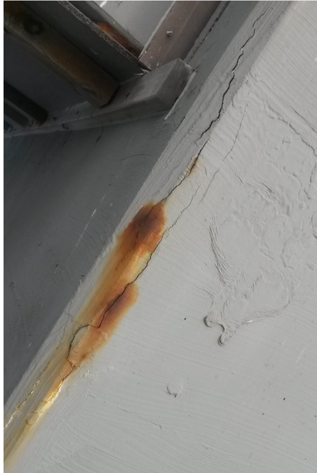
Figur 4.12: Vertikale riss med synlig rust på kanten av tverrbærer og søyle.
