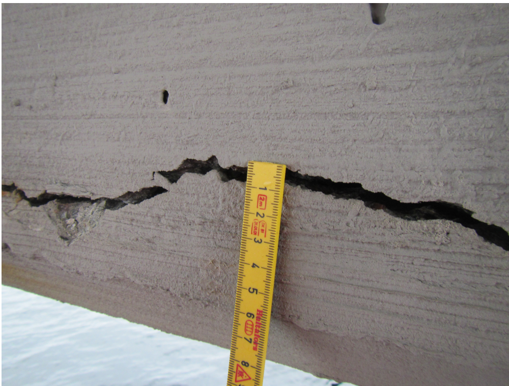
Figur 4.16: Rissvidde på over 6mm. Samme horisontale riss som de tre bildene over
