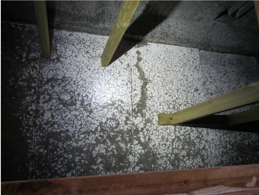
Figur 4.21: Kalkutslag i underkant brudekke. Bilde er tatt loddrett opp fra inspeksjonsluke
