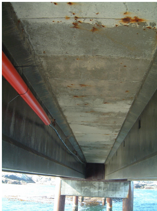
Figur 4.23: underkant brudekke mellom akse 9 og 10
