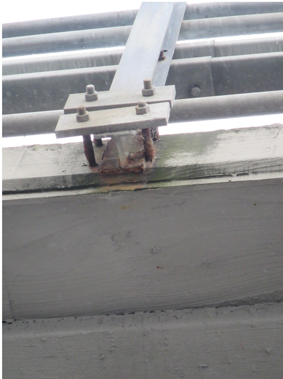
Figur 4.25: Korrodert rekkverk ved innfesting. Ukjent plassering
