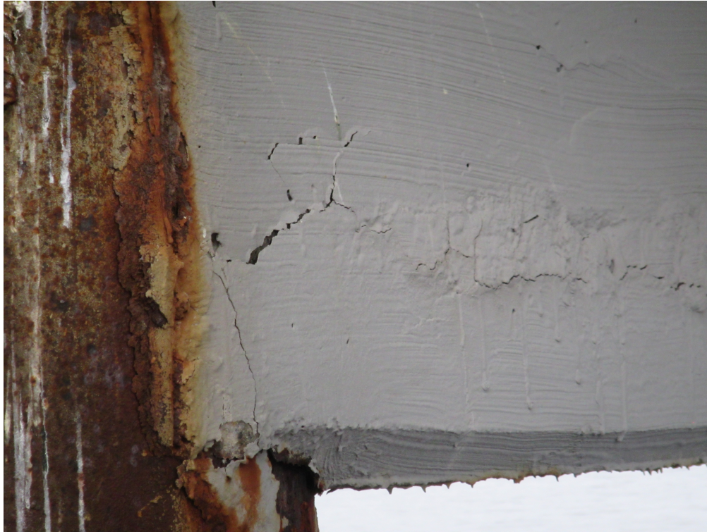
Figur 4.19: Riss og bom ved søylen
