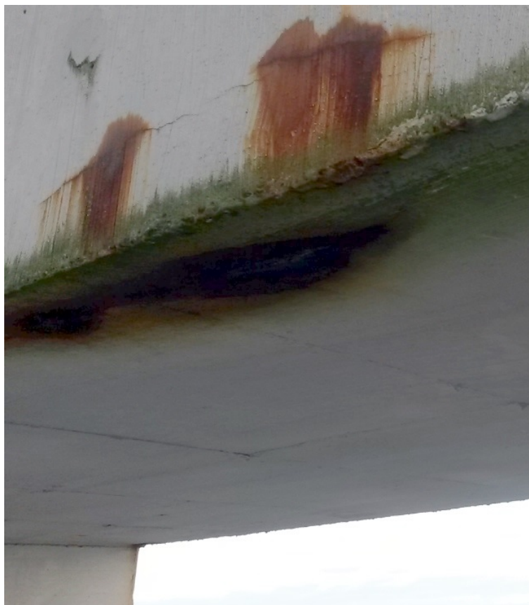
Figur 4.11: Langsgående riss på grunn av armeringskorrosjon
