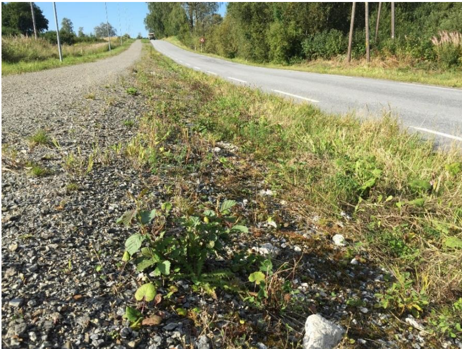
Bilde 3 Grusdekke og manglende grøft. Av Eigil Andersen 08.09.15
