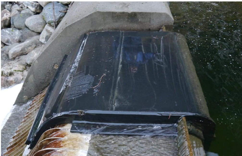
Figur 7 Snorkelen som er montert på Dyrkorn. Her sees også planken som er montert på damkrona for å heve vannspeilet.
