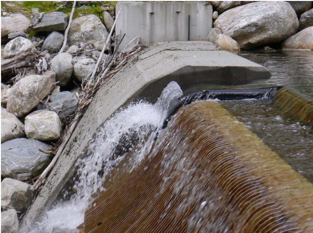
Figur 8 Her er vannføring så stor at snorkelen overtoppes. Dette fører til et ekstra vanntap på grunn av stagene montert på utsiden av snorkelen.
