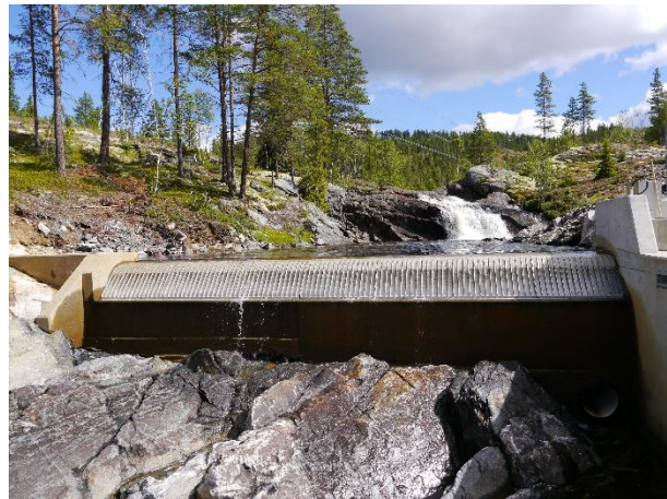
Figur 5 Inntaket til Tverråne kraftverk. Spruten fra Coandarista litt til venstre for midten skyldtes et nylonstrå fra en børste brukt til rengjøring, som hadde satt seg fast i en spalte.
