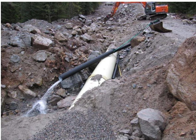
Figur 8 Utvaska fundament ved rør nr 63 – 66. Steinene som har raset ned bak det svarte drenerørret førte til synlige skader på rørvegg. Foto Gjesdal Kraftverk AS
