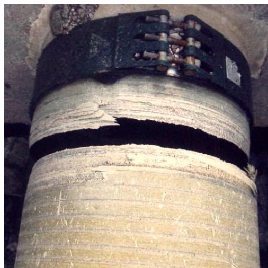
Figur 14 Hylla Kraftverk, erosjon i rørmaterialet pga defekt pakning i rørkobling. Foto: Eidsiva
