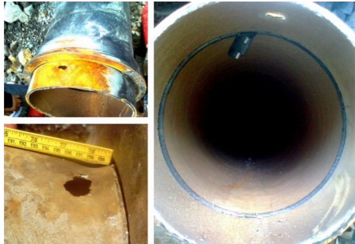
Figur 7 Indre Jåstad kraftverk, vannstrømmen virvlet opp sand og steiner slik at det eroderte hull i rørveggen. Foto: Jåstadkraft
