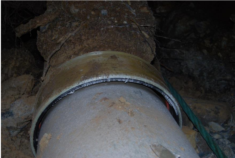
Figur 19: Rørbrudd nr 4 ved Føssa Kraftverk. PN25 muffe. Kilde: Føssa Kraft AS/NVE
