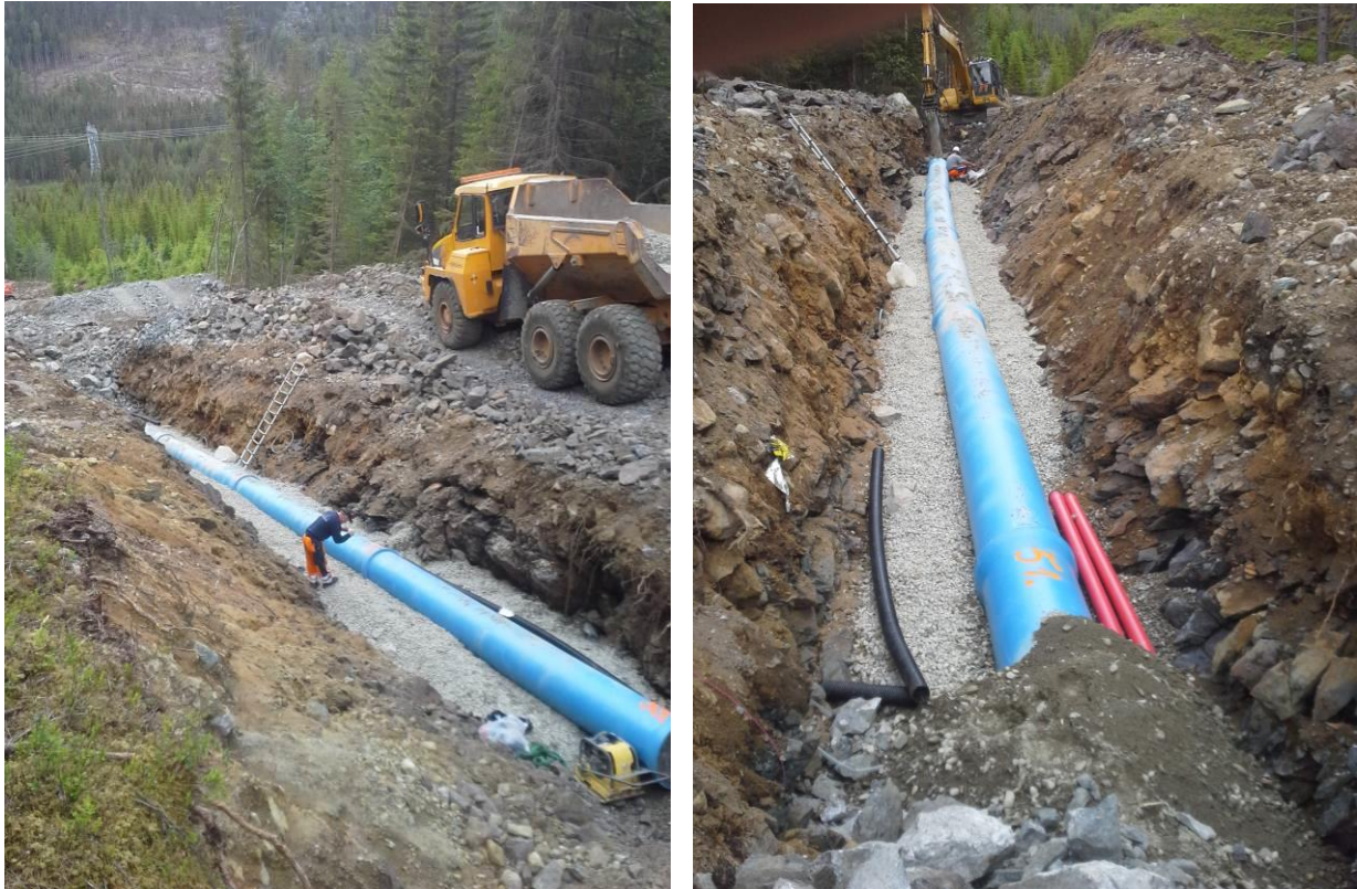
Figur 28: Nybuelve kraftverk, oversiktsbilder bygging av rørgate. Entreprenør i gang med bildetaking og egenkontroll til venstre, graving av grøft til høyre.. (Foto Tor Oxhøvd Svalesen)
