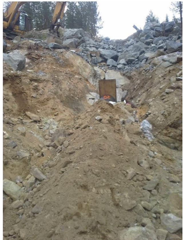
Figur 21: Tverråne kraftverk, nedfylt rørgate ca 200 meter opp for kraftstasjonen. Masseprøve M2 er tatt i dette området. (Foto: Tor Oxhøvd Svalesen)
