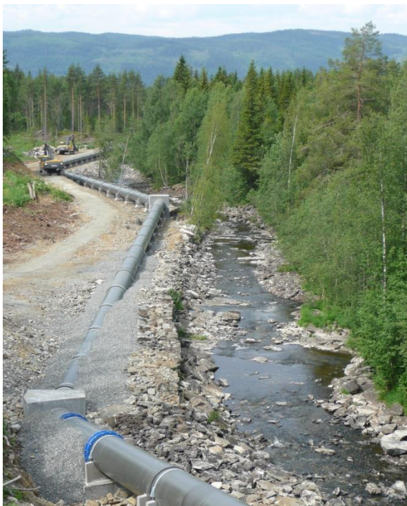
Figur 29: Rørgate Fall kraftverk med betongklosser på hver retningsendring. Bruk av strekkfaste skjøte burde vært vurdert. (Foto: Arne Hamarsland, NVE)
