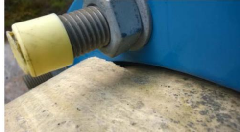
Figur 22 Sprekk i GRP-rør Birkås kraftverk. Foto: Småkraft AS
