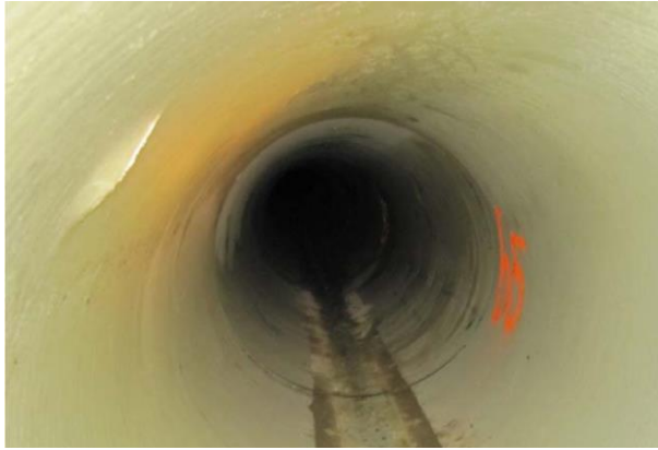
Figur 9 Slagskade fra stein som har falt ned etter utvasking av fundament og omfyllingsmasser rør nr 65. Foto Gjesdal Kraft AS
