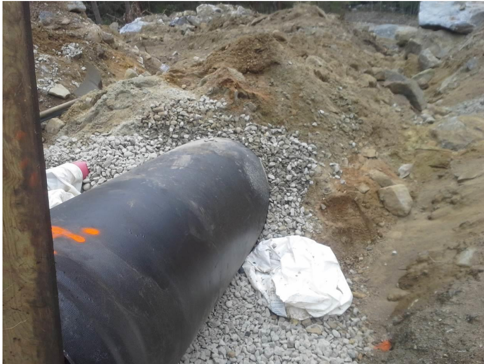
Figur 23: Tverråne kraftverk ca 200 meter opp for kraftstasjonen, nedfylt rørgate, tilsynelatende med pukk rundt hele eller store deler av røret. (Foto: Tor Oxhøvd Svalesen)
