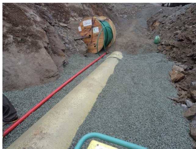
Figur 12: Utlegging av strømkabel og trekkerør. Overfylling med 0-22 mm bærelag etter komprimering før fylling av stedlige masser. Foto: Tor Oxhovd Svalesen
