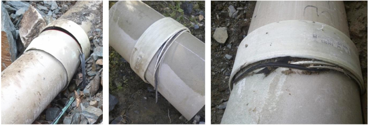
Figur 17 De tre bruddene pga svikt i muffene så langt ved Føssa kraftverk: venstre bilde 24. juni 2011, midten 14.juni 2012 og til høyre 12.08.2012. Kilde: NVE/Føssa Kraft AS
