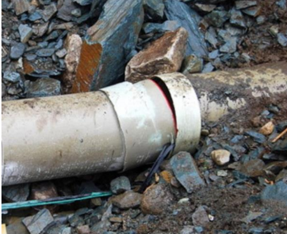
Figur 12: Rørbrudd ved Føssa Kraftverk juni 2011. Foto Edvin Bakken
