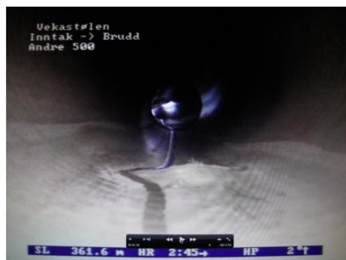
Figur 5: Mosbakka kraftverk, stillbilde fra kamerainspeksjon. Kilde: Ragnar Hartmann
