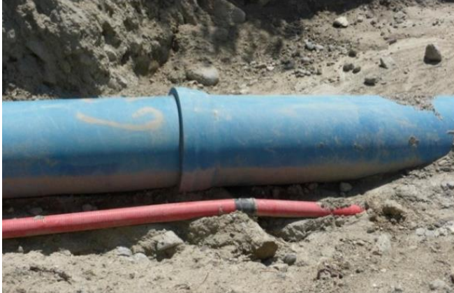
Figur 4: Rørgate ved Finnesetbekken kraftverk. Legg merke til mangelfullt rørfundament og trebit under muffa. Kilde: Kolbjørn Dønåsen AS/Ragnar Hartmann
