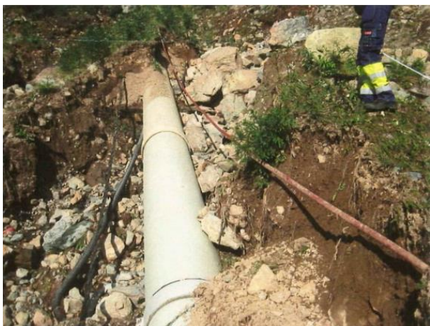
Figur 15 Følgeskade 70 meter nedstrøms bruddstedet med utvasking av omfyllingsmassene. Foto: Eidsiva
