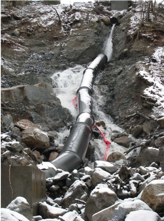
Figur 16 Skadd rørstrekning Kanndalen kraftverk. Til venstre for bendkloss vises spor etter bekk som antas å ha medført erosjon/utvasking. Foto: Småkraft AS
