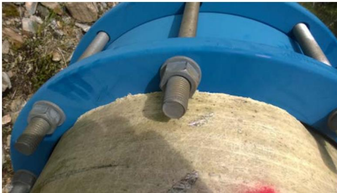
Figur 23 Sprekk i GRP-rør pga avvinkling i muffe. Foto: Småkraft AS
