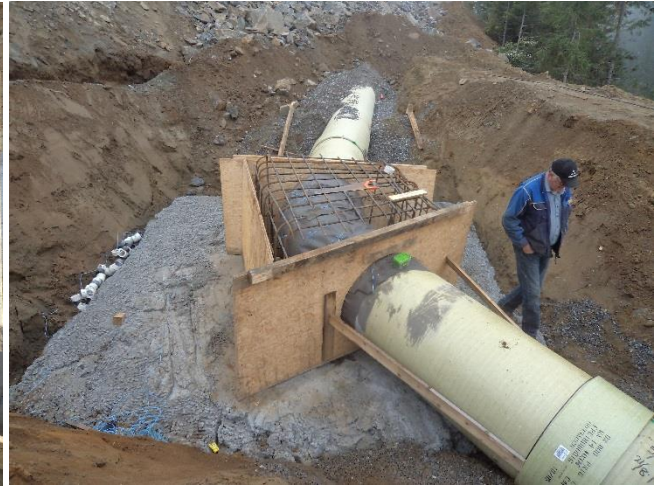
Figur 17: Bend B7. Legg merke til størrelsen på plata i forhold til selve klossen rundt røret. Foto: Tor Oxhøvd Svalesen
