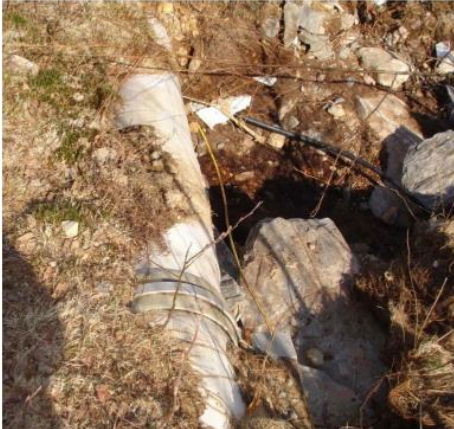
Figur 1: Brudd ved Sægrov kraftverk våren 2009. Kilde: Hartman (2012)
