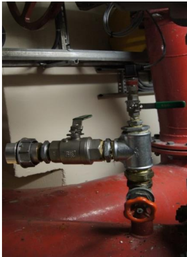
Figur 44 Ventil og montert trykkmåler på Frostakaia (Foto VN)
