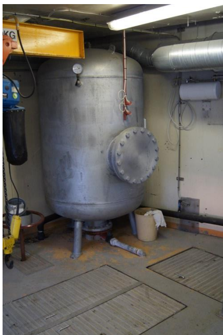
Figur 29 Luftputekammer på Brattørbrua pumpestasjon (Foto VN)
