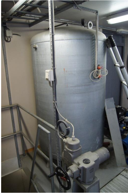
Figur 31 Luftputekammer på Frostakaia pumpestasjon (Foto VN)
