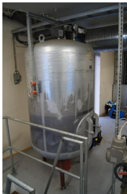
Figur 30 Luftputekammer på Lillegata pumpestasjon (Foto VN)
