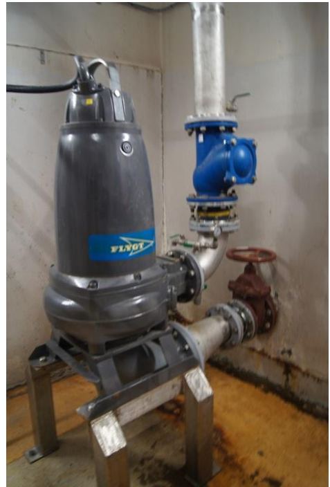
(b) Flygt 3202.180, Brattørbrua pumpestasjon
