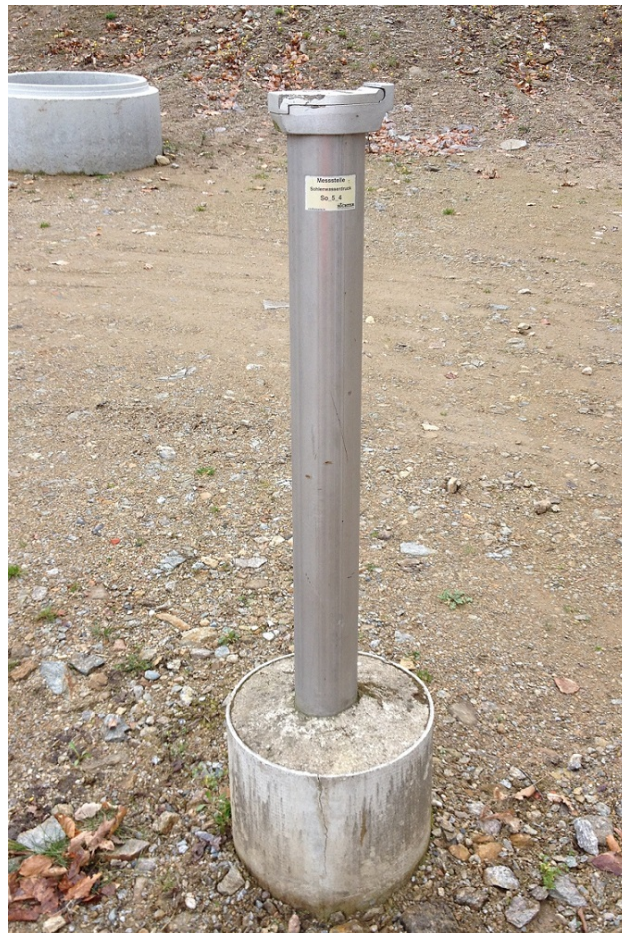
Figur 2.6: Topp av standrør uten meter plassert nedstrøms dammen
