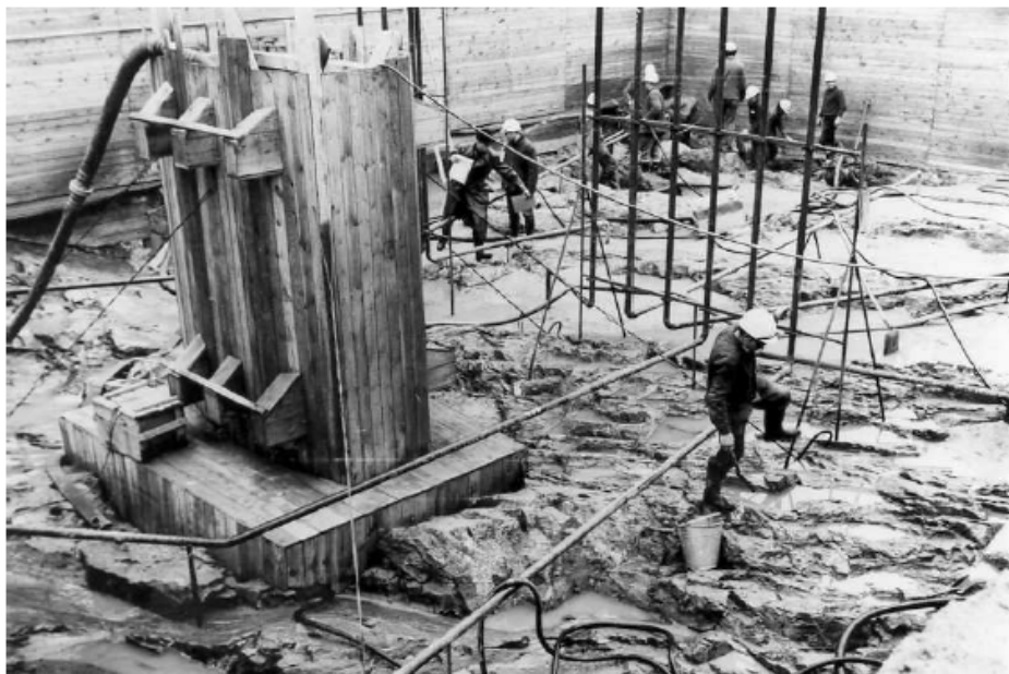
Figur 3.4: Avbøyning av rør ved fundamentet slik at flere rør går samlet vertikalt opp til inspeksjonsgangen (LTV, 2006)
