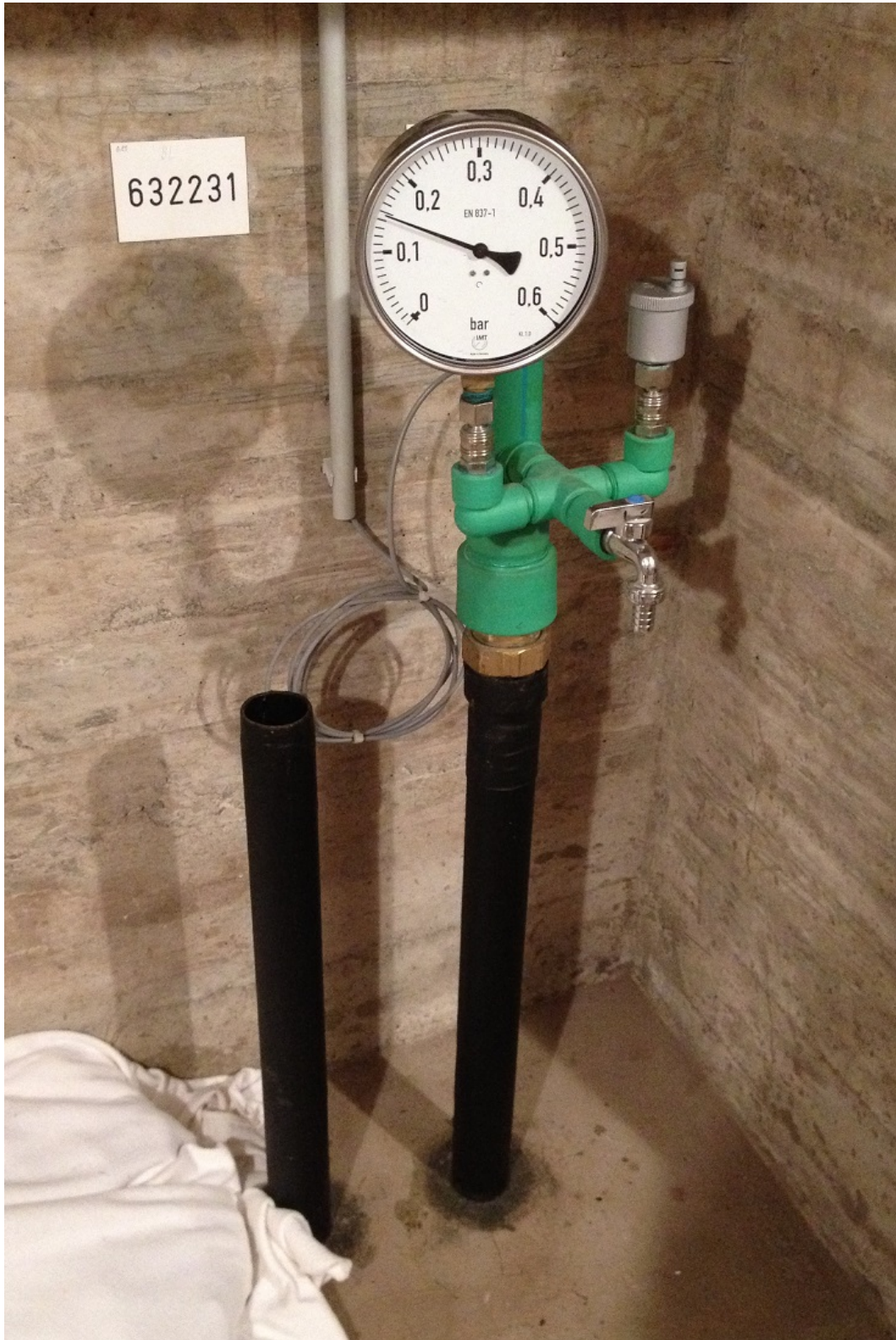
Figur 3.7: Topp av standrør med meter plassert i inspeksjonsgangen
