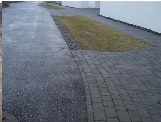
Figur 16 Kantene er forsterket med belegningstein for å hindre skader fra kjøretøy. Foto: Tore Leland
