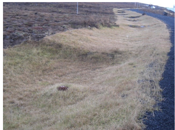
Figur 82 Bratte partier forseres med trappefall. Utløpet er hevet over bunnivået i grøfta for å la overvannet infiltrere. Urridaholt, Island. Foto: Tore Leland
