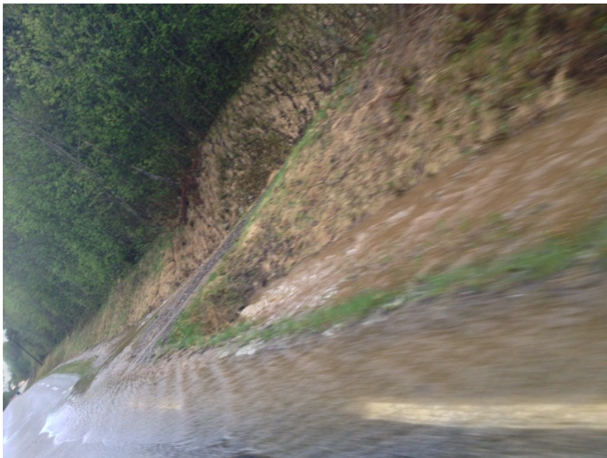
Figur 70 Stikkrenner er et kritisk punkt. Dersom den hydrauliske kapasiteten ikke er tilstrekkelig kan det oppstå oppstuvning og oversvømmelse. Foto: Tore Leland
