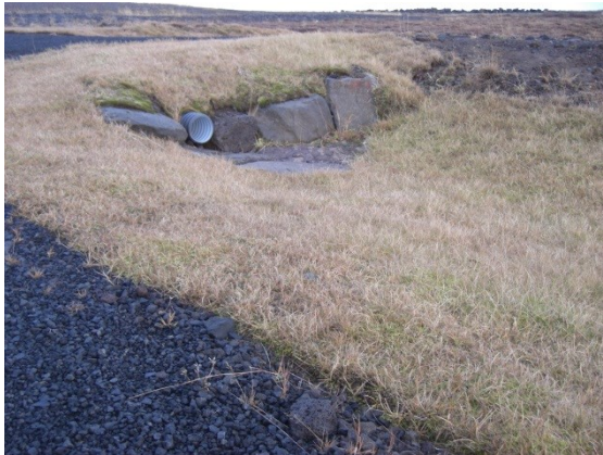
Figur 15 Konsentrerte innløp og trappfall er sikret med steiner for å hindre erosjon. Foto: Tore Leland
