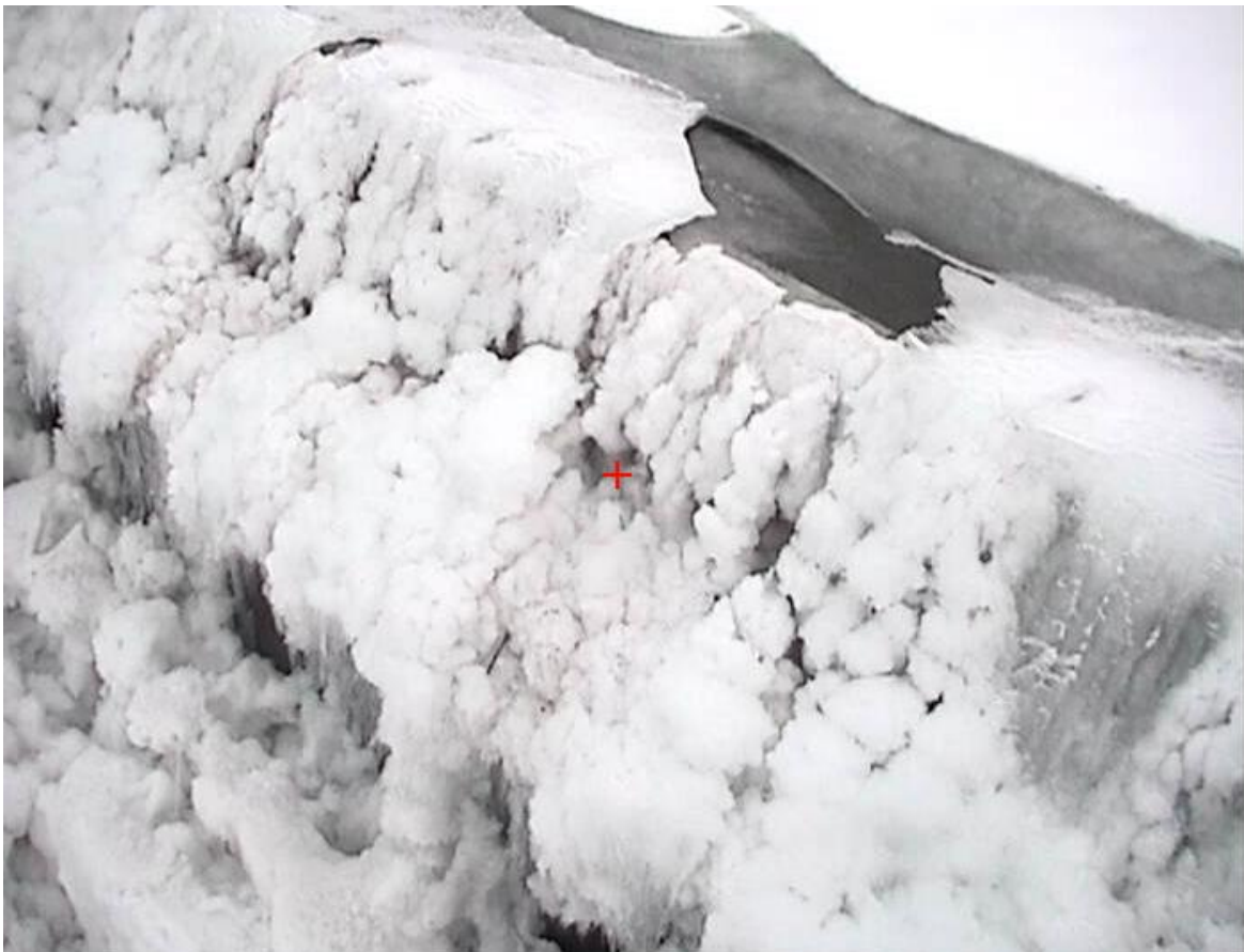
Figur 23: Coandarist med fritt innløp vann under islag (Foto: Tafjord Kraftproduksjon AS)
