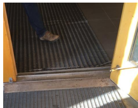
Figur 36 Hovedinngang med terskel og bratt kile.
