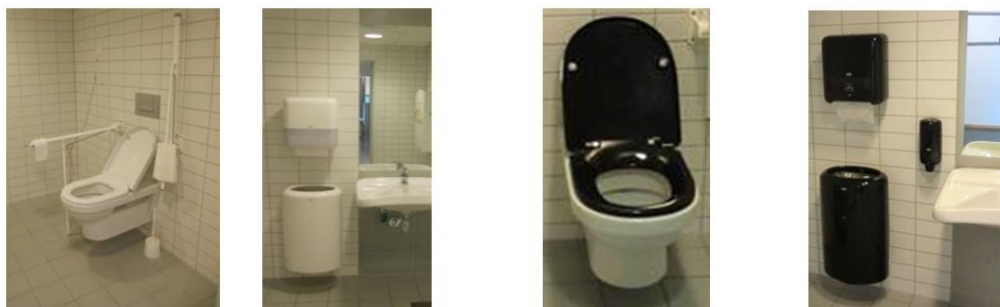
Figur 24 Toalettet før og etter kontrastering av fastmontert utstyr, Høgskolen i Sør-Øst Norge
