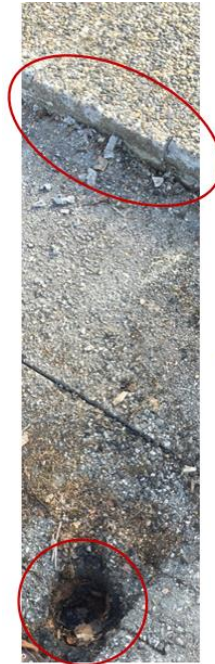
Figur 40 Kant og hull i gangsti mellom inngang og HC-parkering.
