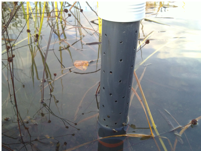
(c) Trykksensor til overløp plassert i rør med innløpshull 6 cm over regnbedoverflaten.
