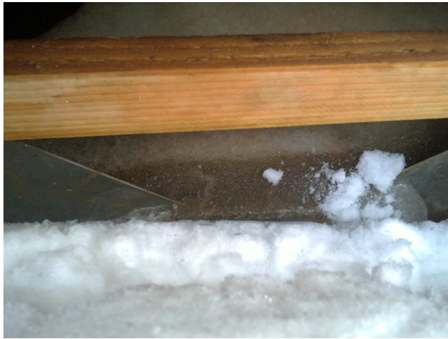
(b) Gjenfryst V-overløp etter drenerøret
