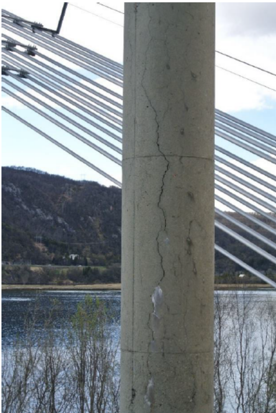
Figur 2.3: Nordre pilar mot sør i akse 2, utsatt for riss
