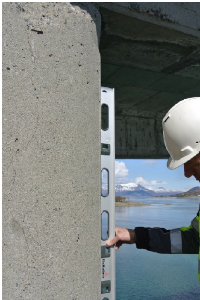
Figur 2.5: Deformasjon av betongpilar
