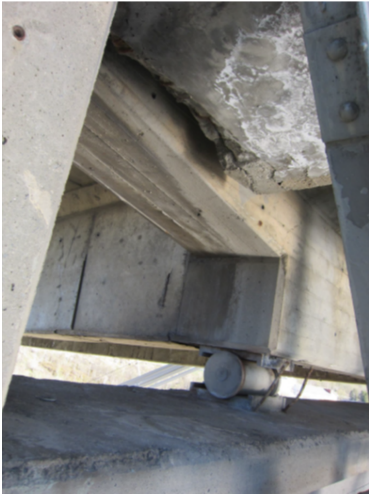
Figur 2.2: Avskalling på rullelager i akse 1, nordlig side. (Aas-Jakobsen, 2014)
