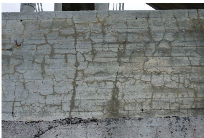
Figur 2.4: Betongfundament med krakelering i akse 1
