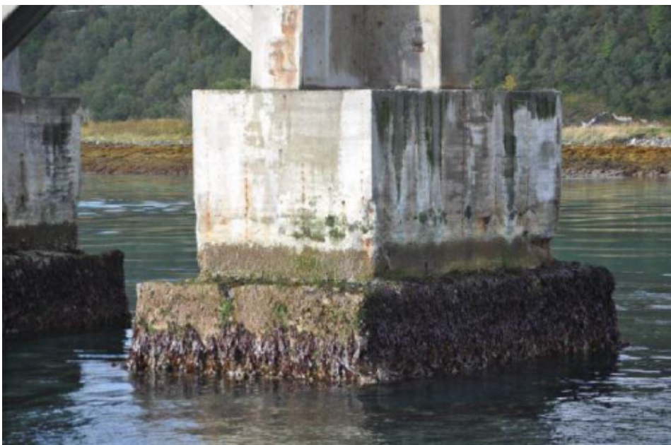
Figur 2.6: Misfarget og begrodd fundament
