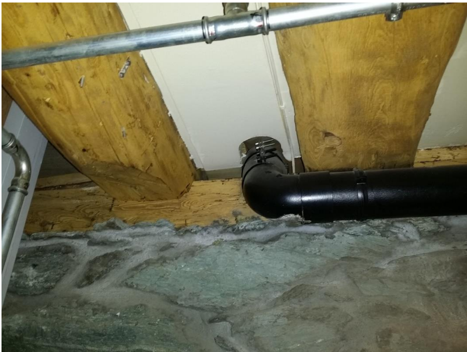
Figur 14: Ingen tettemidler for gjennomføring
