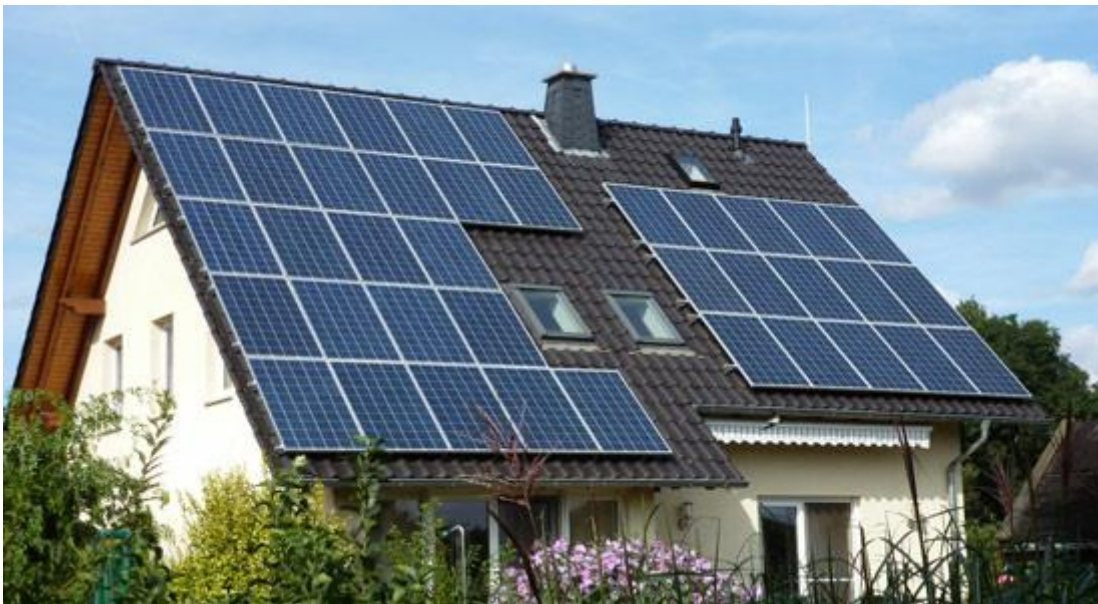
Figur 3 Solcelleanlegg, foto hentet fra http://www.pv-log.com/Resources/Public/Images/home-pv-anlage4.jpg
