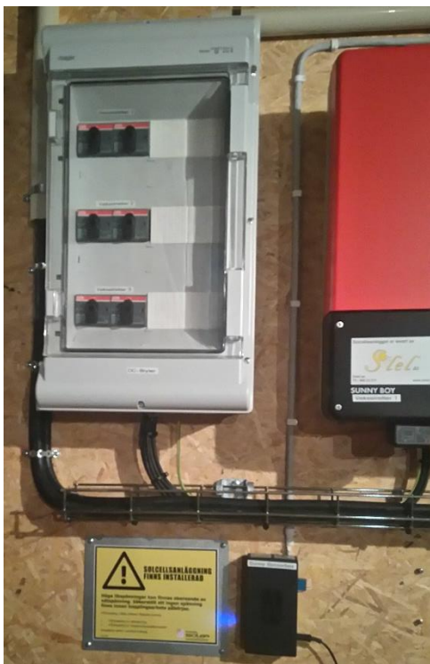
Figur 4 Bryter på DC-side av anlegget plassert ved siden av inverterene. Foto: Eirik Smeplass
