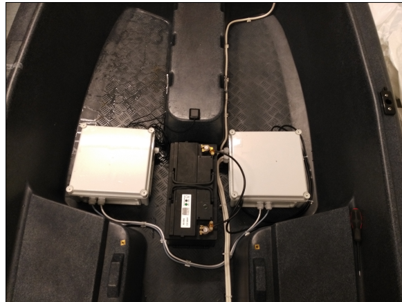
Figur 4.18: Plassering av batteri og kapslinger
