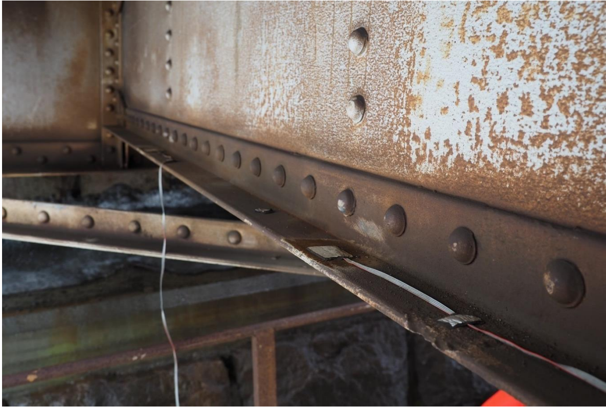
Figur 17 Den midtre sensoren plassert på Lerelva bro
