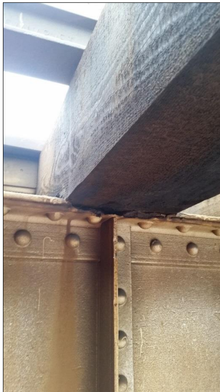
Figur 4.5 Korrosjonsskader toppflens langbærer
