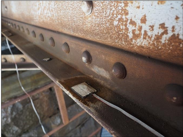
Figur 2.3 Tøyningssensor på underflens
