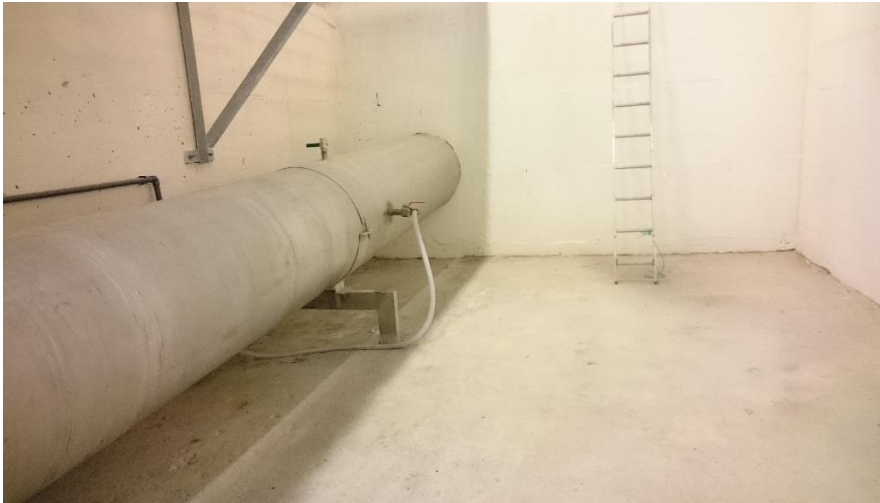
Figur 18. Tilsetning av Klorgass ved Ålesund vannverk.
