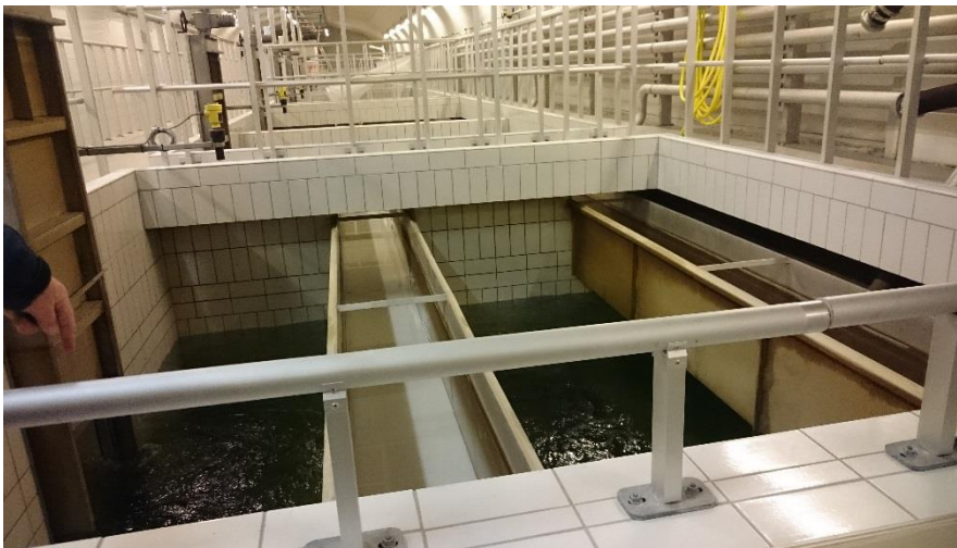
Figur 19. Marmorfilter ved Ålesund vannverk.
