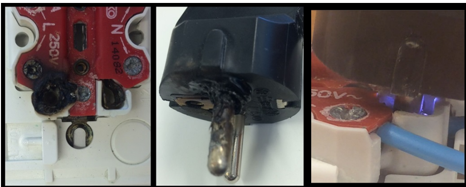
Figur 6.23: Resultatene etter lysbuer mellom stikkontakt og støpselet
