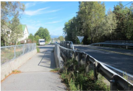
Figur 1.1.2: Eksisterende gangbru er for small til at den kan brøytes[1].
