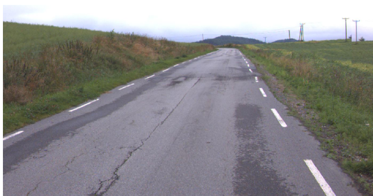
2012 Dekket viser tegn til ustabile grunnforhold.
