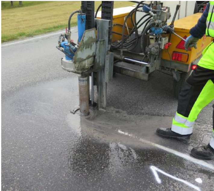
Figur 18: Boring av asfaltprøver på Fv 222 sør for Stange. (Foto: Viktor Hedfors, Jan Fredrik Hertenberg)
