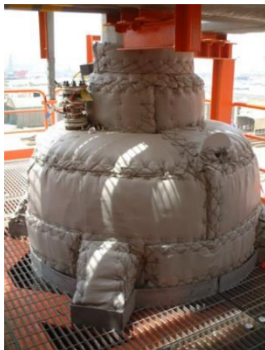
Figur 8.5: Isolert beholder på en offshoreinstallasjon [7].
