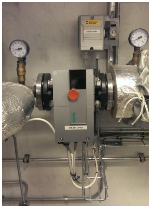
Figur 36 Bilde av pumpe JP401 i system 310.004.
