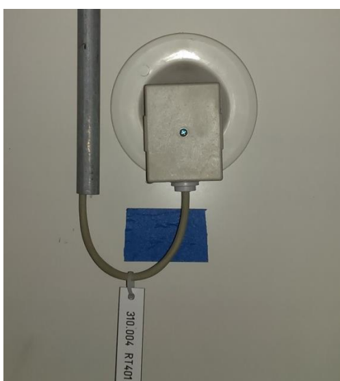
Figur 39 Bilde av temperaturføler RT401 i system 310.004. Plassert på tank NU101.
