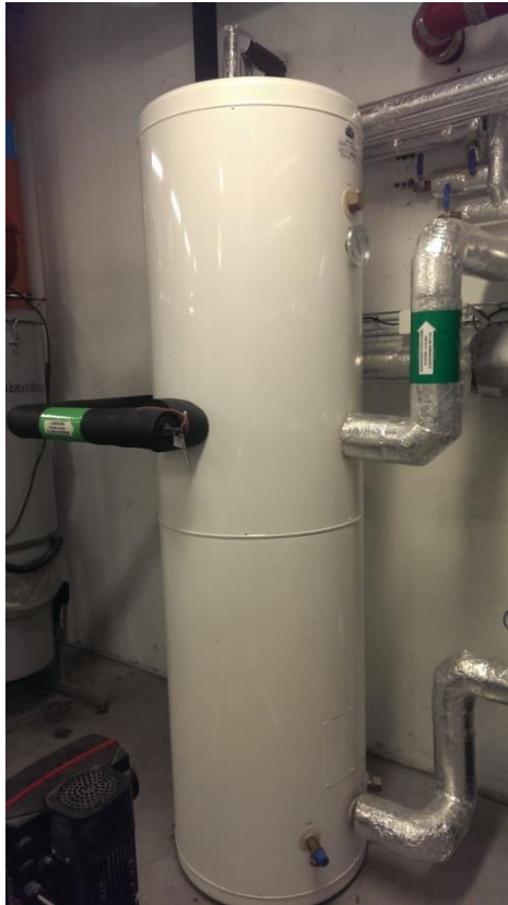
Figur 6 Bilde av varmegjenvinningstanken i system 310.012.
