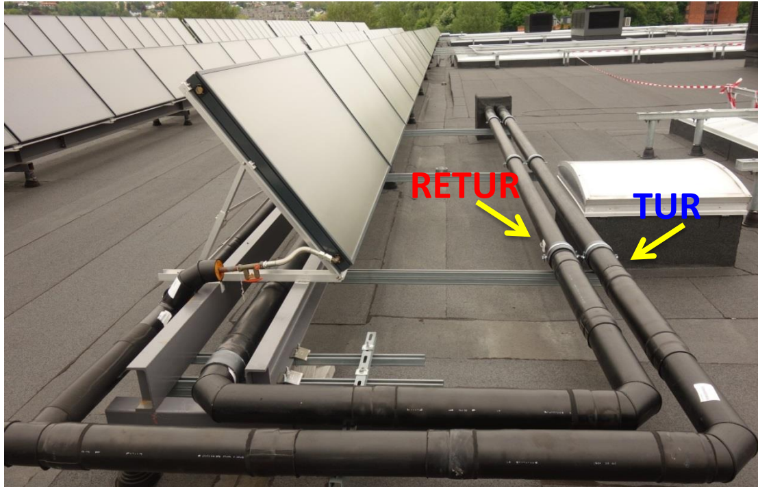
Figur 30 Bilde av felles tur- og returledning for solfangeranlegget på Hotell Scandic Lerkendal
