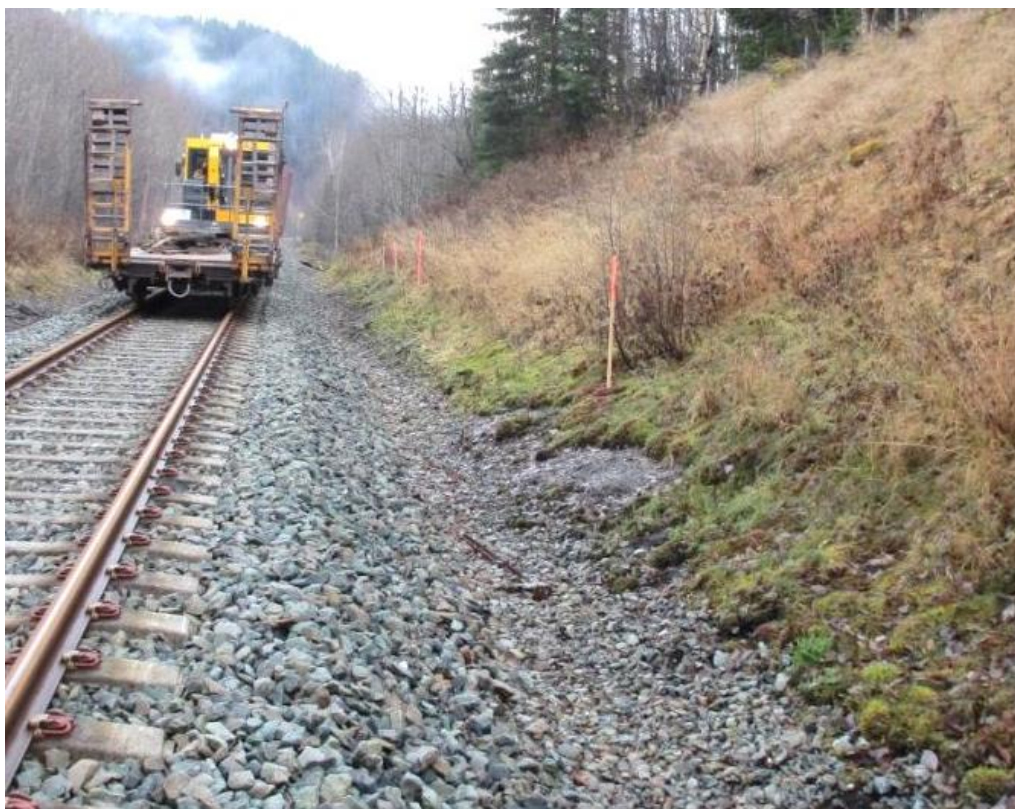
Figur V- 17) Nederste del av skråningen er våt og mosedekket. Det er satt ut stikker i de våteste punktene. Ovenfor stikkene, lenger opp i skråningen, er terrenget nokså tørt. Foto: A. Liereng (5.11.15).
