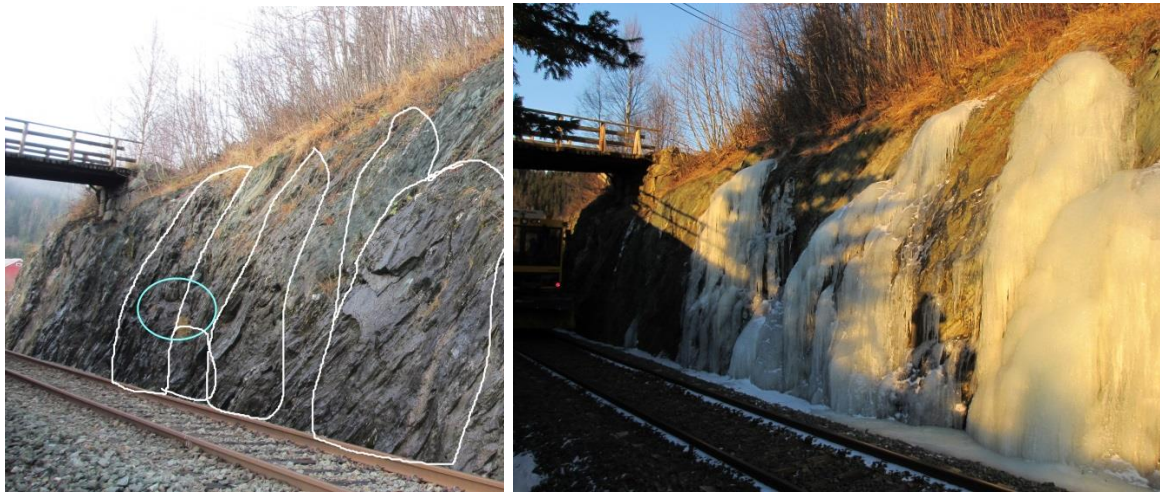
Figur V- 34a) Vestre del av skjæringen. Berget er dryppende vått. Turkis ring viser en åpen sprekk som leder vann ut i skjæringen. Hvite linjer viser plasseringen av iskjøvingene pr 15.1.16. Foto: A. Liereng (5.11.15) b) En del av isen starter i toppen av skjæringen, og en del is starter midt i skjæringen ved markerte sprekker. Foto: A. Liereng (15.1.16)
