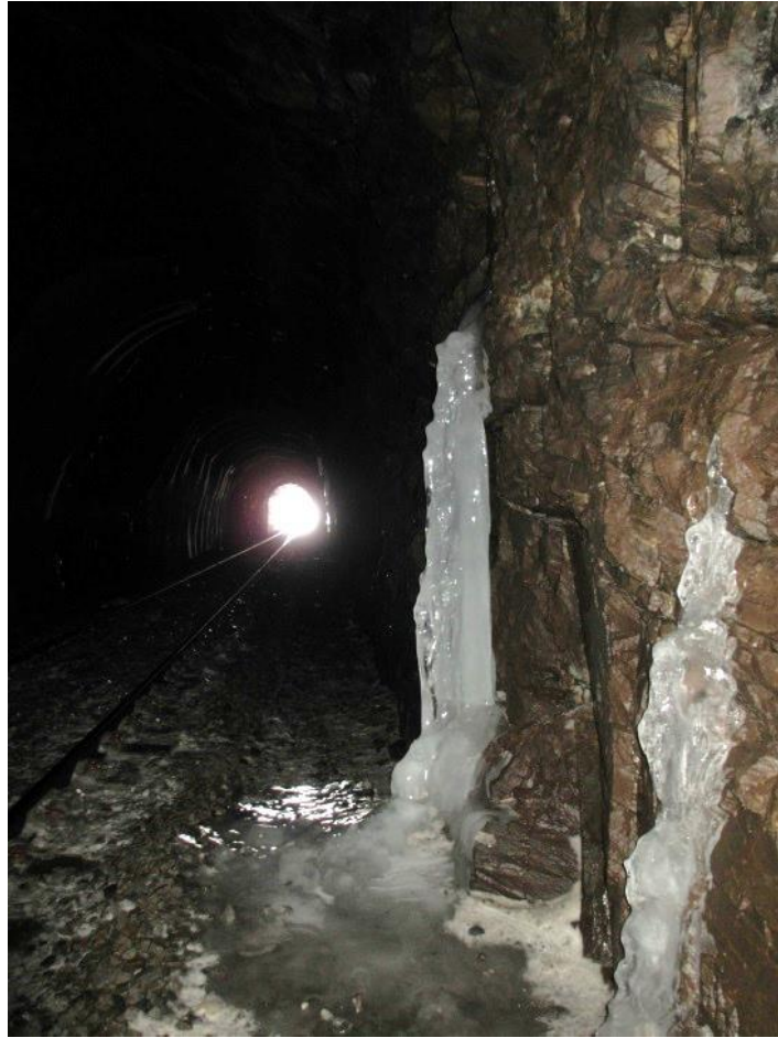
Figur 15) Iskjøving i Hjartåsen tunnel, Nordlandsbanen. Foto: A. Liereng (15.3.16).
