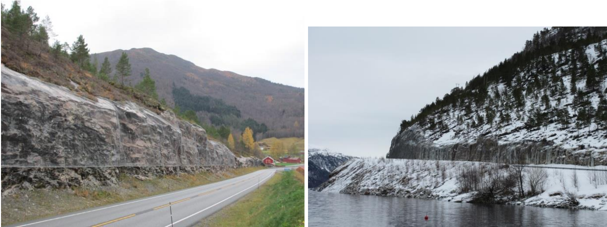
Figur V- 65a) Ved Engdalen er det en lang og høy skjæring i bunnen av en fjellside. Skjæringen er sikret med isnett. Foto: A. Liereng (3.11.15) b) Skjæringen kutter gjennom de tynne løsmasse- og jordlagene over berget. Foto: A. Liereng (9.3.16).
