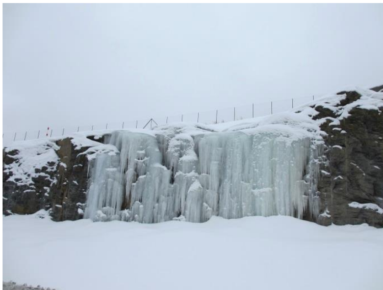
Figur 65) Konsentrert iskjøving i østre del av skjæringen. Den lukkede drenggrøfta i berget klarer ikke samle alt vannet. Foto: A. Liereng (11.3.16).
