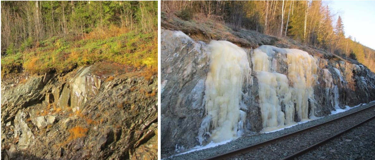
Figur V-22a) Detaljbilde av toppen av skjæringen om høsten. Det renner ut grunnvann i laggrensa mellom berg og løsmasser. Skjæringen var tydelig våt selv i tørt vær. Foto: A. Liereng (5.11.16). b) Iskjøving i skjæringen begynner der berget avdekkes. Foto: A. Liereng (15.1.16)
