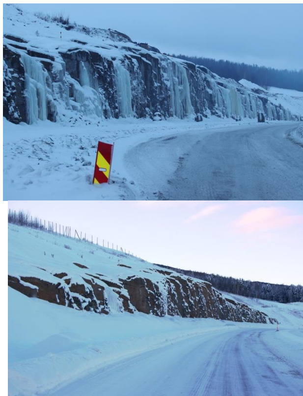
Figur V- 69a) Iskjøving i skjæringen ved Rudland før tiltak. Isen er jevnt fordelt langs skjæringen. Foto: Roar Holten, Statens vegvesen (Januar 2015). b) Skjæringen etter tiltak. Iskjøvingen er betraktelig redusert. Foto: Roar Holten, Statens vegvesen (Januar 2016).
