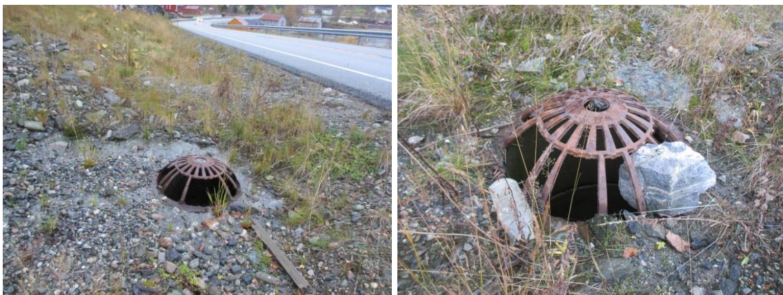
Figur 86a) Enkelte av stengene i rista er fjernet for å hindre iskjøving. b) Vegetasjon, stein og søppel kan samle seg i ristene og kummene. E39, Vinjefjorden. Foto: A. Liereng (3.11.15).
