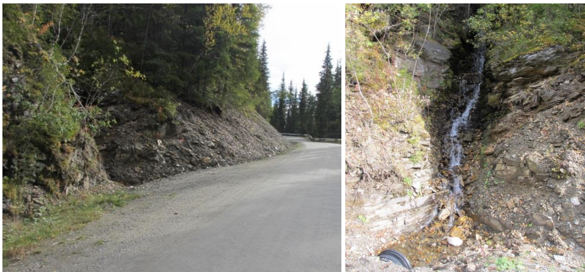
Figur 81a og b) Eksempel på godt utformet bekkeløp og innløp til stikkrenne langs Tann-Annolsetervegen. Bekken renner i en dyp og smal nedføringsrenne. Det var ingen iskjøving i stikkrenna vinteren 2015/16. Foto: A. Liereng (20.9.15).
