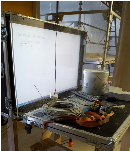
Figur 33: Rot på BIM-kiosk 1 (Betonmast)
